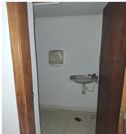
(figura 24 – banheiro da sala 2005)
