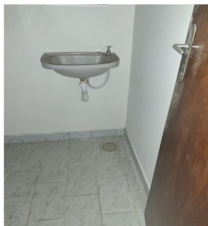
(figura 31 – banheiro da sala 2003)
