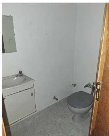
(figura 2 – banheiro da sala 2004)
