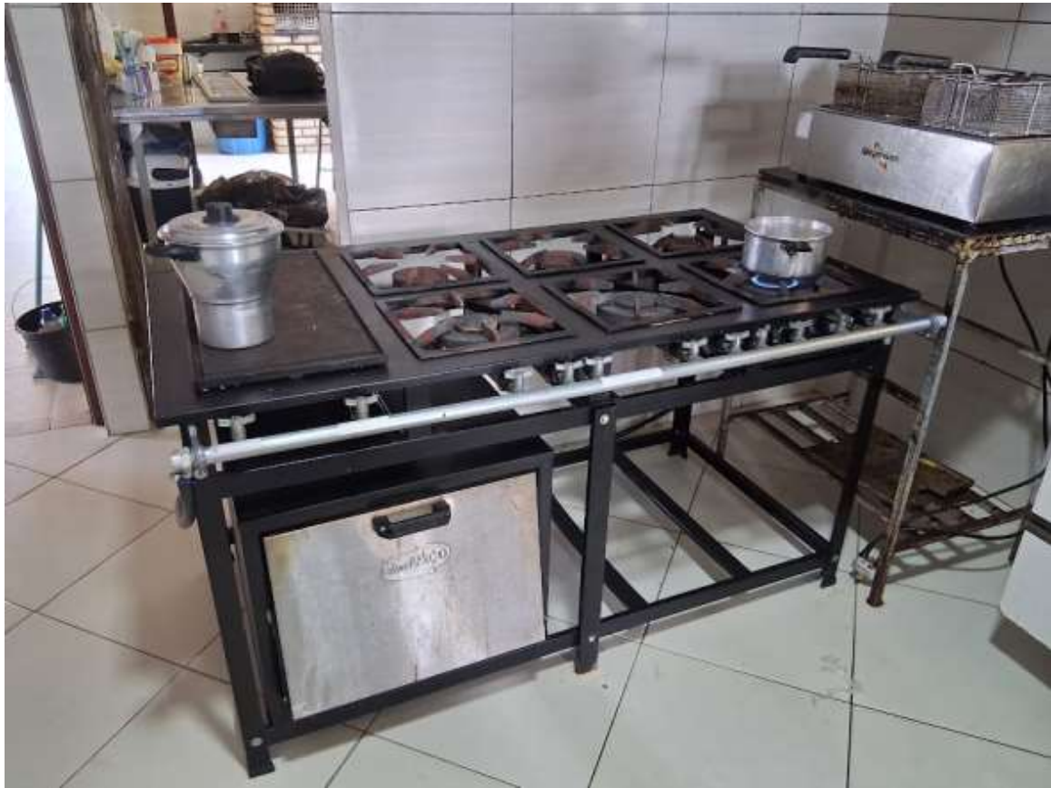
FIGURA 02: FOGÃO INDUSTRIAL A GÁS
