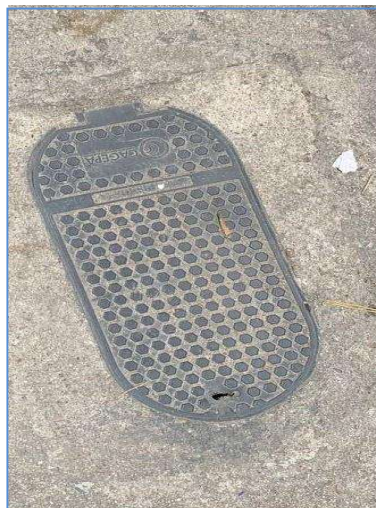
Figura 20 – Medidor de água (Calçada)
