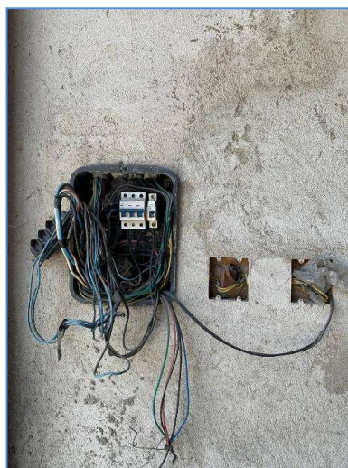
Figura 16 – Quadro de energia com fiações expostas, em desacordo com a NBR 5410
