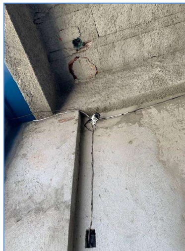
Figura 18 – Instalação elétrica exposta, em desacordo com a NBR 5410. (Câmera de segurança)
