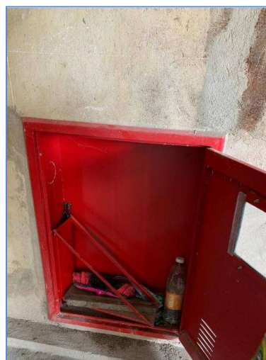
Figura 22 – Instalação de combate a incêndio inacaba. (desativado)
