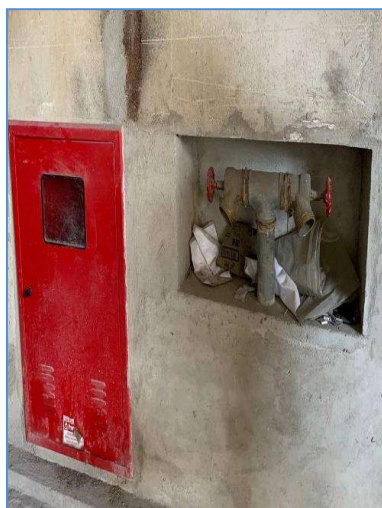
Figura 21 – Instalação de combate a incêndio inacaba. (desativado)
