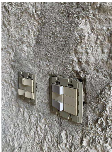
Figura 15 – Instalação elétrica inacaba, em desacordo com a NBR 5410
