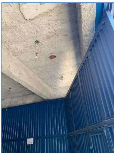
Figura 17 – Instalação elétrica exposta, em desacordo com a NBR 5410 e portão de alumínio (garagem).
