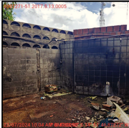
Foto 17 – Vista da área degradada do imóvel 1.
