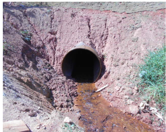
FOTO: 16 Tubulação de passagem água
