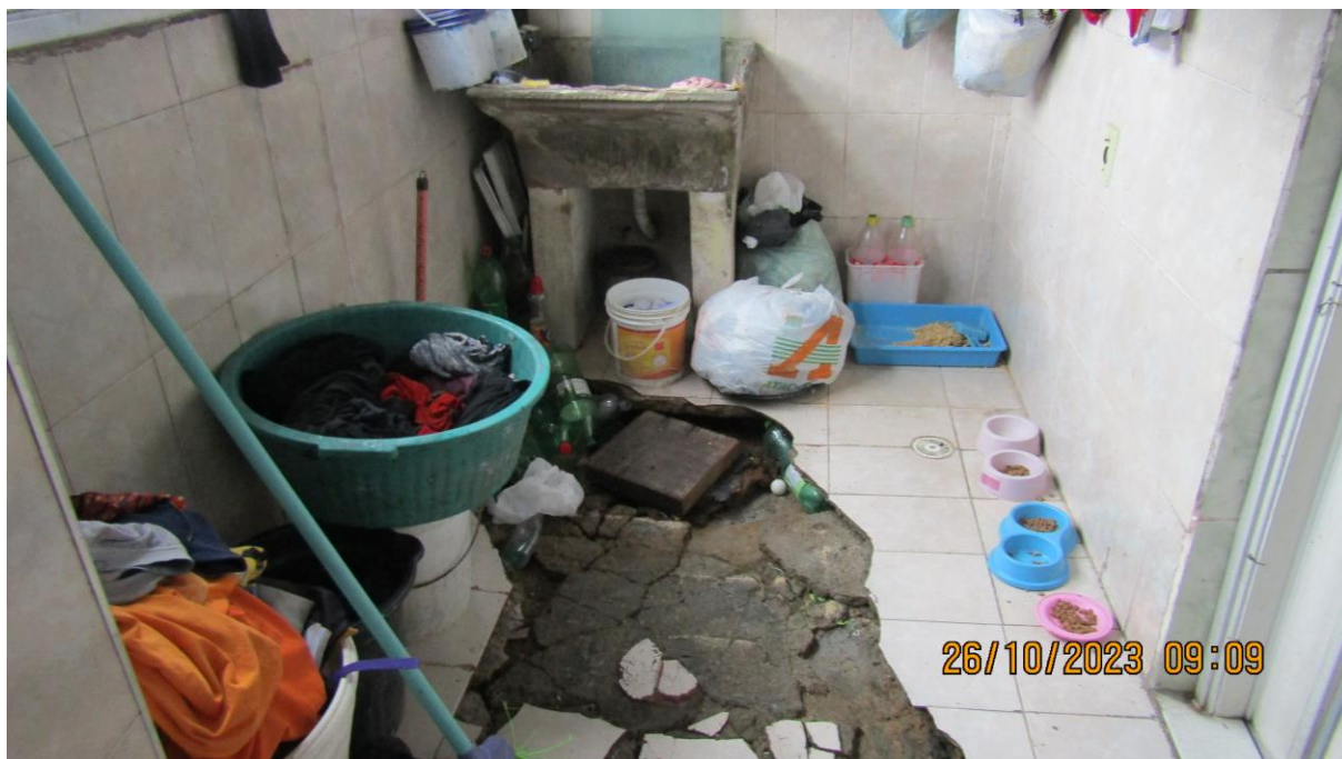
Foto 18 – Detalhes da área de serviço. Note-se de que o piso encontra-se danificado.
