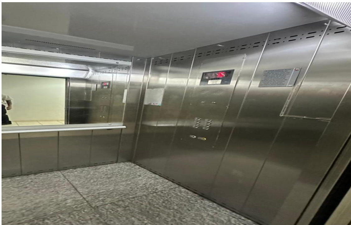
Visão interna do elevador
