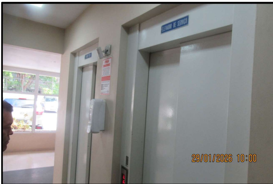
Foto nº 18: Vista dos 2 elevadores de serviço existentes.
