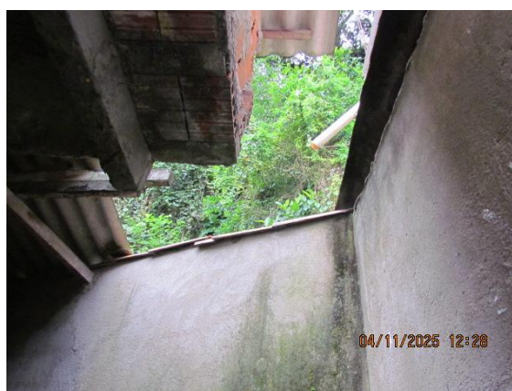
detalhe da visão acima do muro notando alicve na Área de Preservação Permanente
