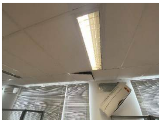
Foto 77 – Detalhe do forro e ar-condicionado
