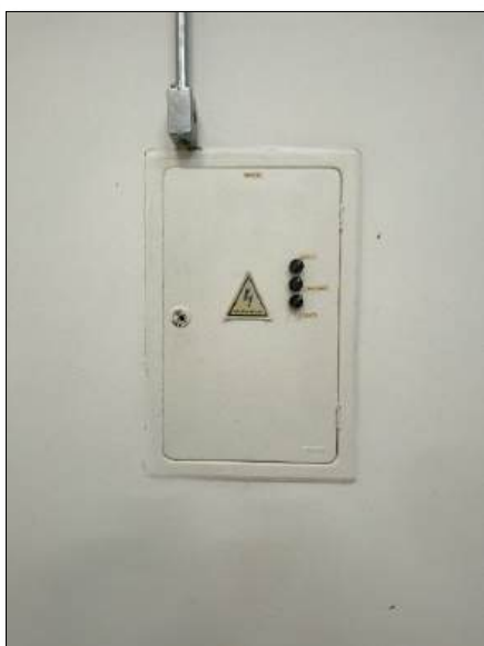
Foto 53 – Quadro de força (térreo)
