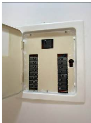
Foto 98 – Quadro de energia
