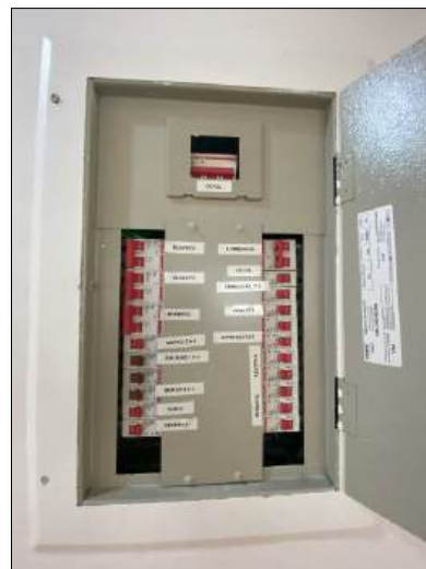
Foto 100 – Quadro de energia
