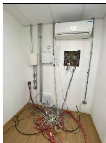
Foto 96 – Sala de equipamentos
