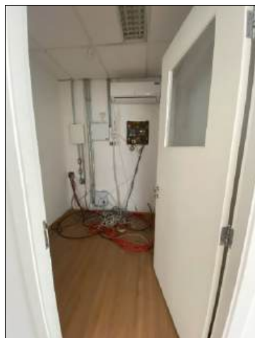
Foto 95 – Sala de equipamentos
