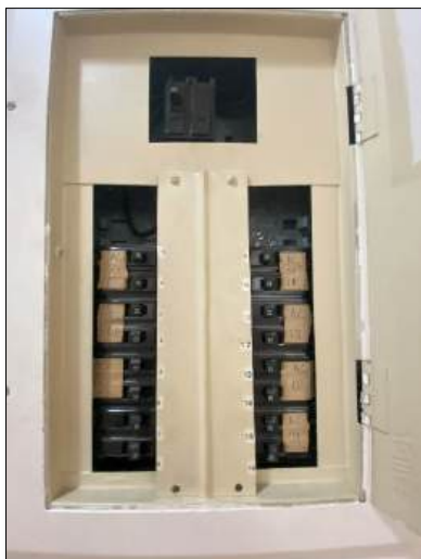
Foto 99 – Quadro de energia
