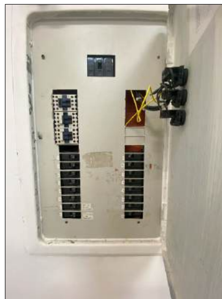
Foto 54 – Quadro de força (térreo)
