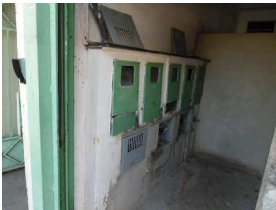
Diversos medidores de água e energia elétrica, configurando situação irregular perante a PMA.
