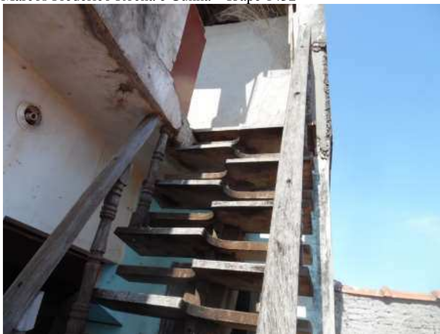
Estado de conservação da escada. Ruim.
