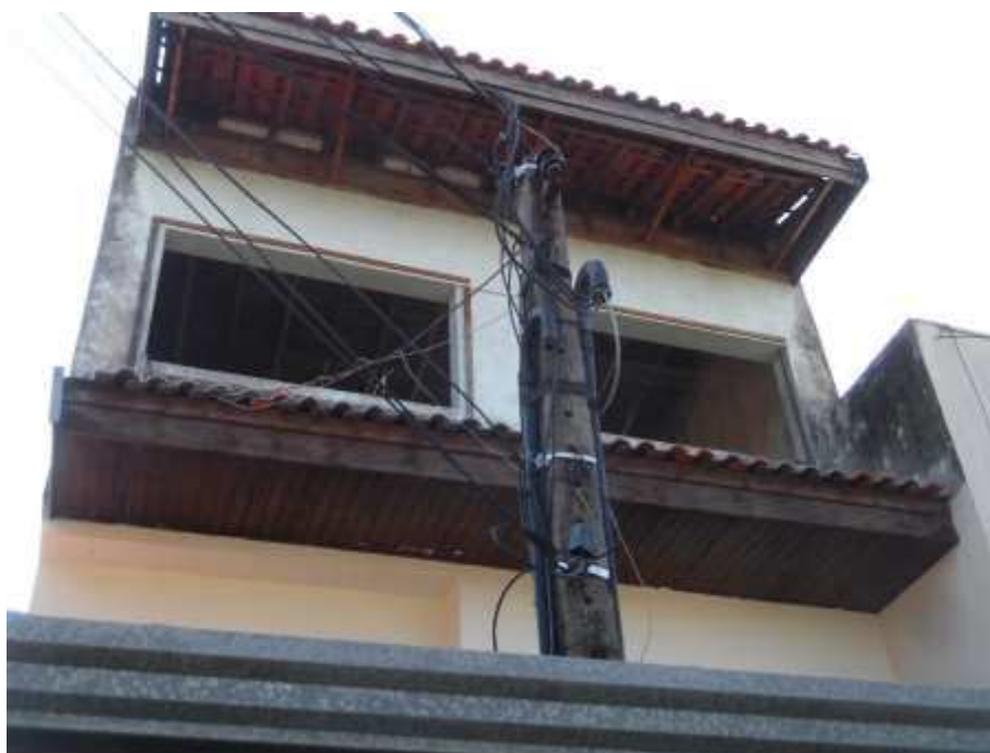
Vista do quarto pavimento da edificação – Irregular.
