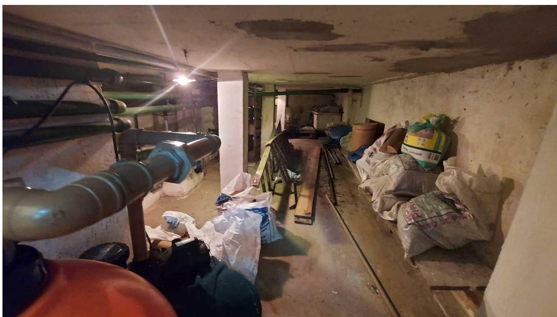
Foto 10: Sala de manutenção da piscina – Subsolo
