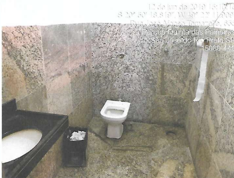
Foto 30 – vista do banheiro / imóvel 04.
