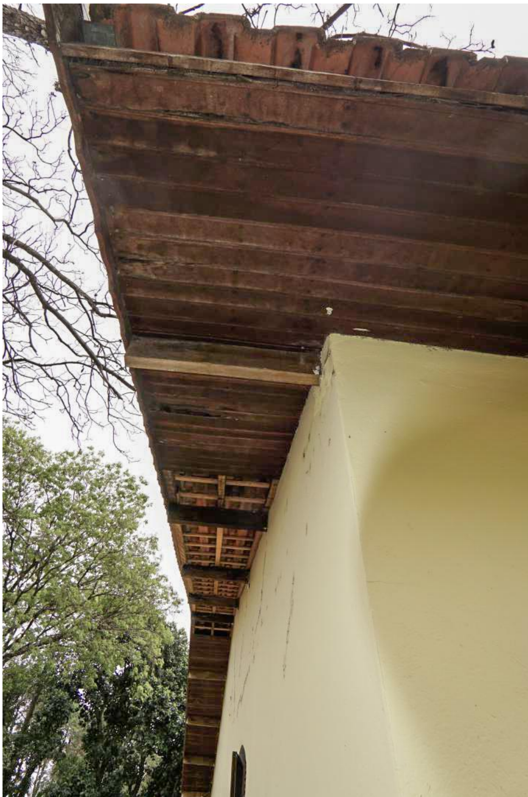
Figura 17. Devido ao incêndio podemos ver pontos degradados da estrutura do telhado.
