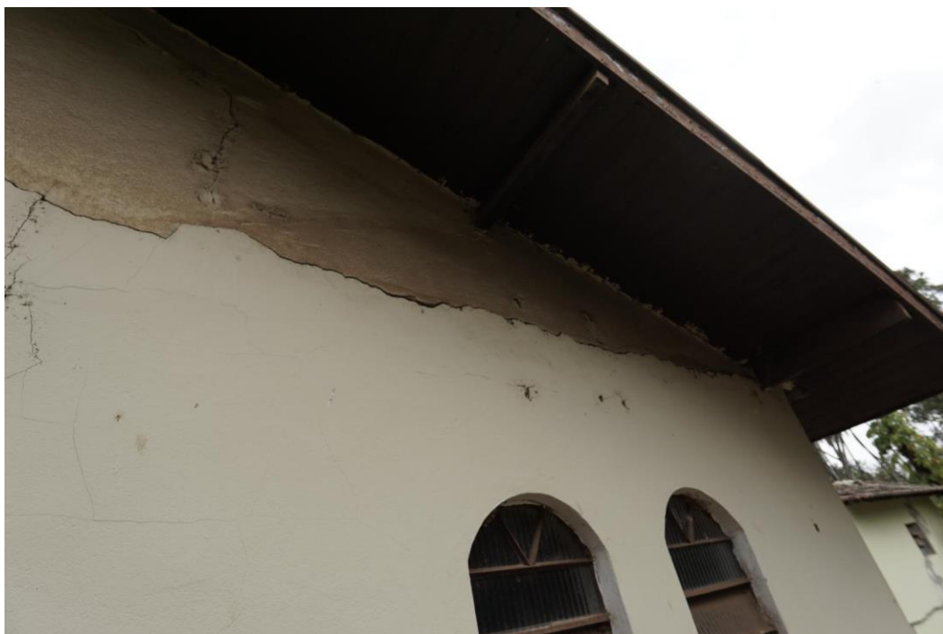
Figura 25. Casa 2, com fissuras.
