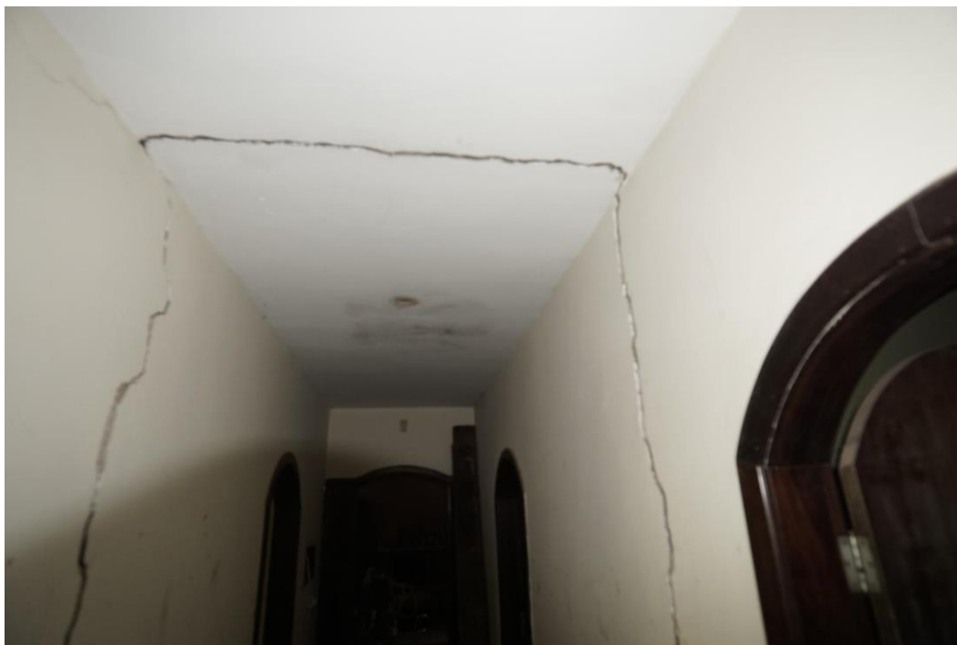
Figura 28. Casa 2. possui fissura no meio atravessando a casa inteira.
