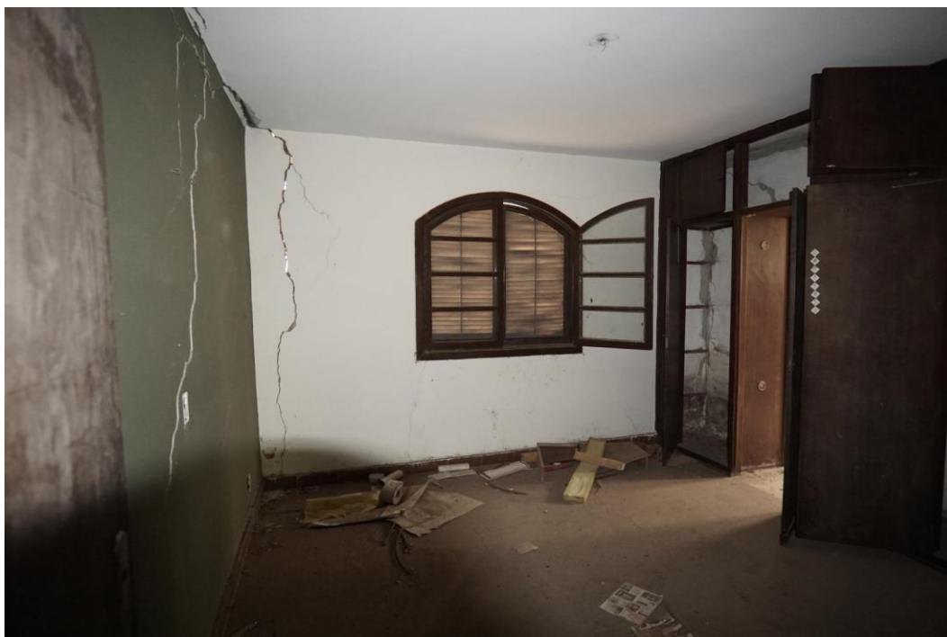
Figura 29. Casa 2. Fissura na casa inteira. Esta casa está condenada.
