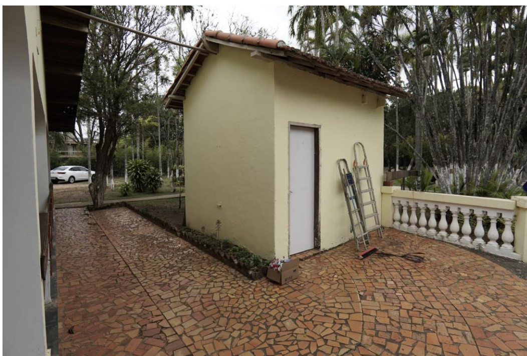
Figura 19. Casa de bombas da piscina.
