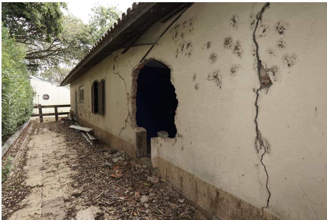
Figura 26. Casa 2. Em péssimo estado de conservação.
