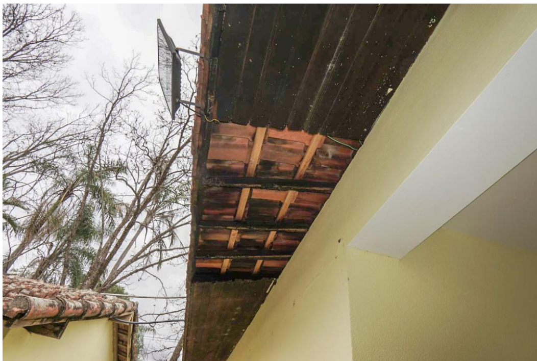
Figura 16. A casa principal sofreu um incêndio e foi reformada pelo locatário. Porém ainda vemos pontos da estrutura queimada.
