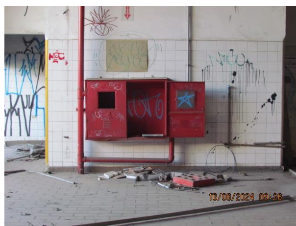
vista de caixas de incêndio com mangueiras e acessórios metálicos retirados
