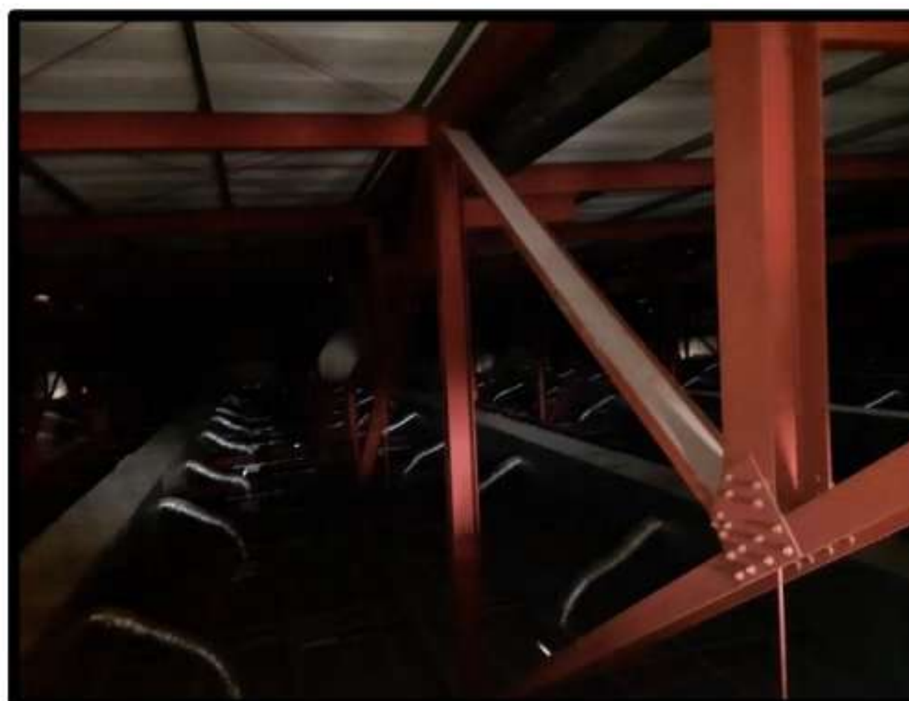
FOTO 41 - VIGAS E SISTEMA DE AR CONDICIONADO
