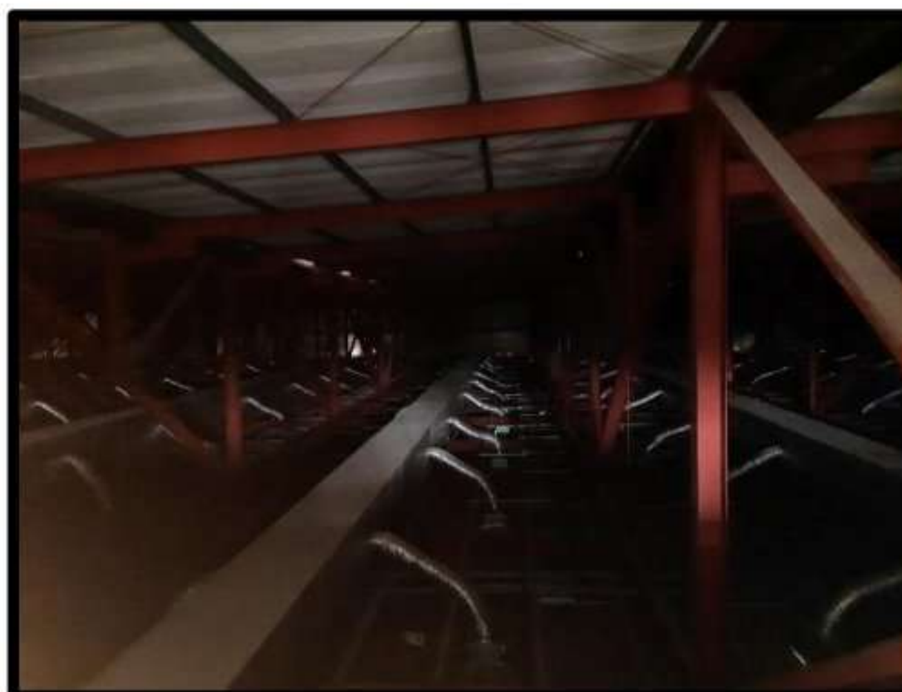
FOTO 40 - VIGAS E SISTEMA DE AR CONDICIONADO
