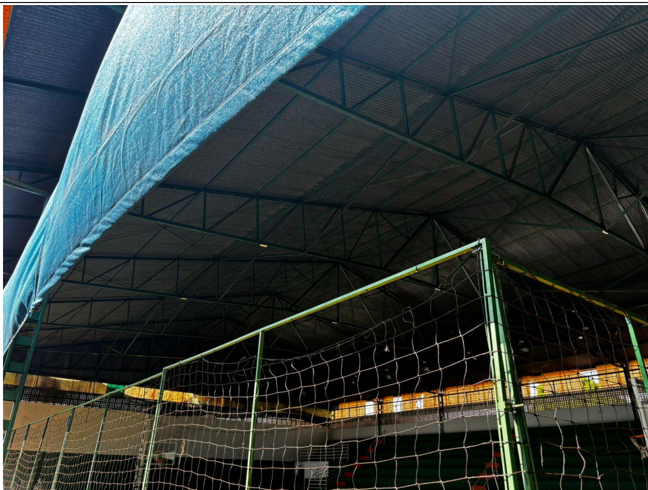
FOTO 05 – Vista parcial da lateral da cobertura. Nota-se o beiral após a lona
