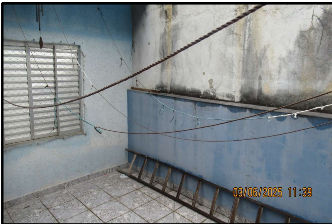
Foto nº 7: Detalhe da alvenaria com fissuras e trincas e manchas de umidade em avançado estado de depreciação.
