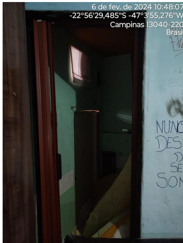
FOTO 51 – CASA III – BANHEIRO DESATIVADO
