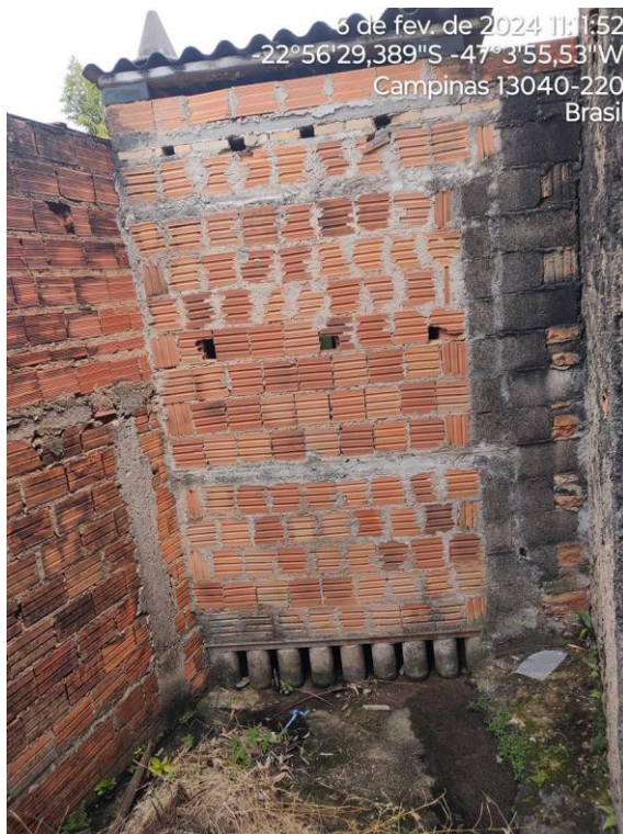
FOTO 57 – CASA III – VIELA SANITÁRIA
