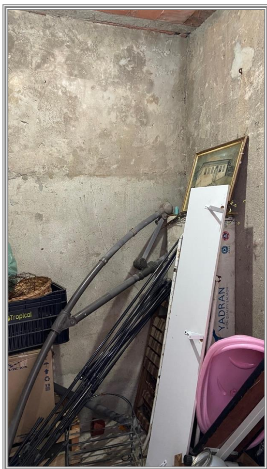
Comentário (♦): Vista genérica do depósito externo. Nota-se que os revestimentos de piso, parede e laje não foram concluídos no ambiente.
