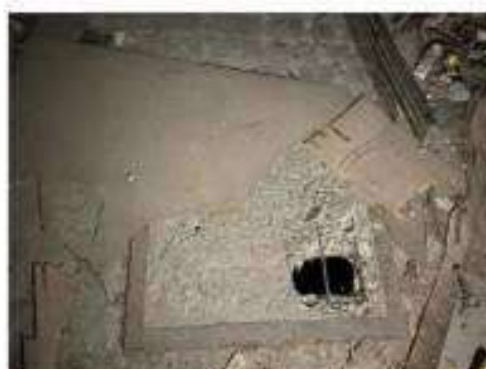
Foto 21 – Vista de caixa de passagem danificada em área desativada no 1º andar.
