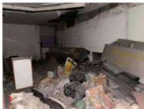
Foto 19 – Vista parcial de área desativada no 1º andar.
