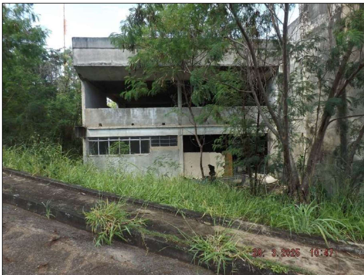
Figura 2: Fundos do Imóvel inacabado
