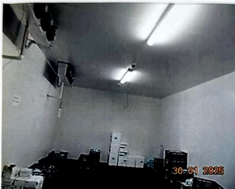
Fotografia 31 – Outra vista da câmara fria
