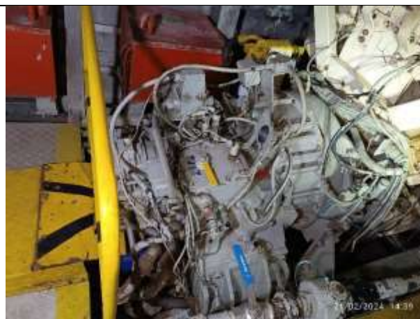
100. Redutora do motor propulsor nº 1
