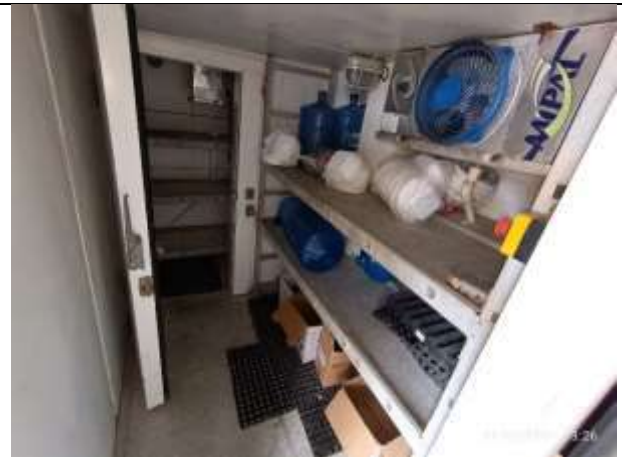
74. Câmara frigorífica de legumes e verduras e de carnes ao fundo
