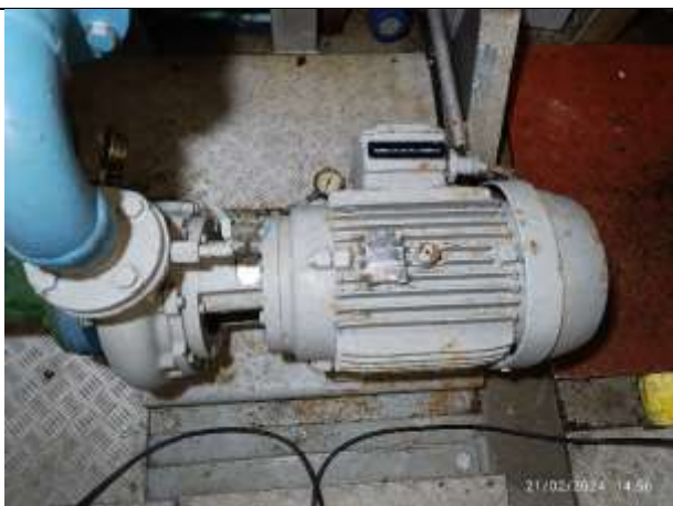
111. Bomba de lastro e incêndio
