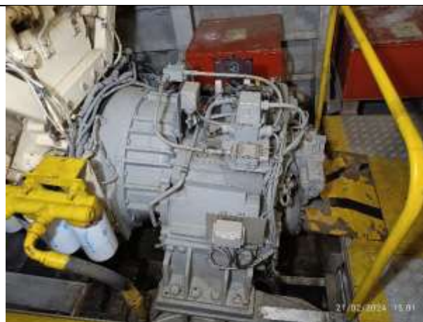
106. Redutora do motor propulsor nº 4
