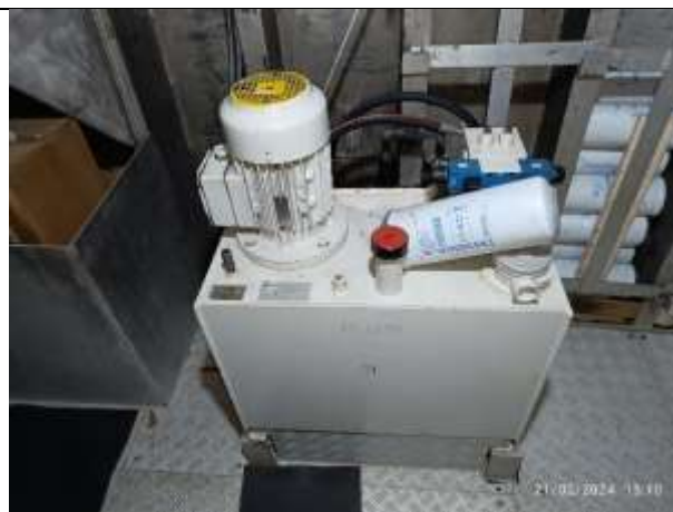
124. Unidade hidráulica da máquina do leme de bombordo
