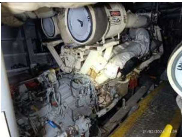
99. Motor propulsor nº 1
