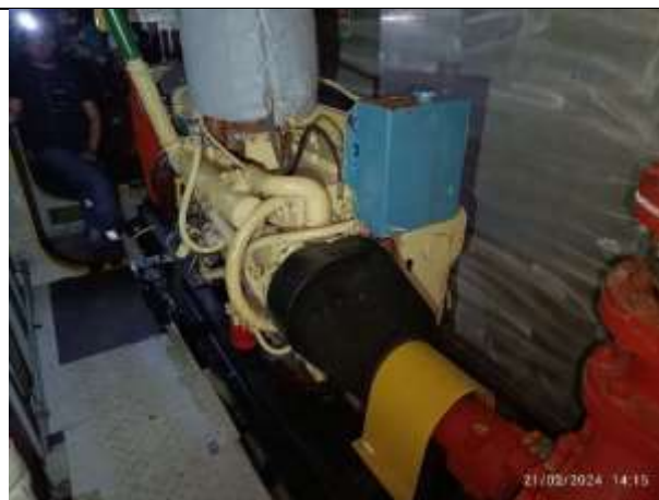
94. Motor diesel da bomba de lama/óleo diesel e bomba do canhão de incêndio
