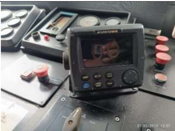
53. Painéis de comando e supervisão dos MCPs 2 e 1 e GPS GP 33
