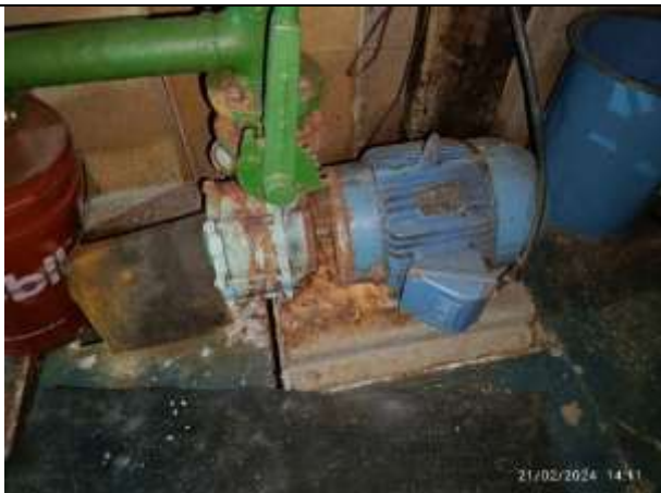
89. Bomba de circulação e refrigeração do ar condicionado
