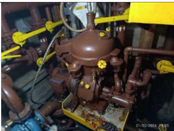
109. Purificador de óleo diesel
