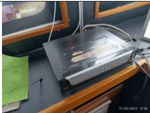
Suite do sistema de monitoramento
