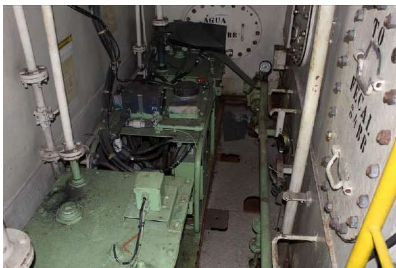
- Unidades de tratamento séptico e bomba de transferência de dejetos.
