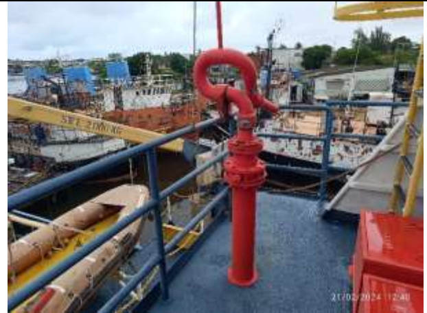
20. Canhão de combate a incêndio
