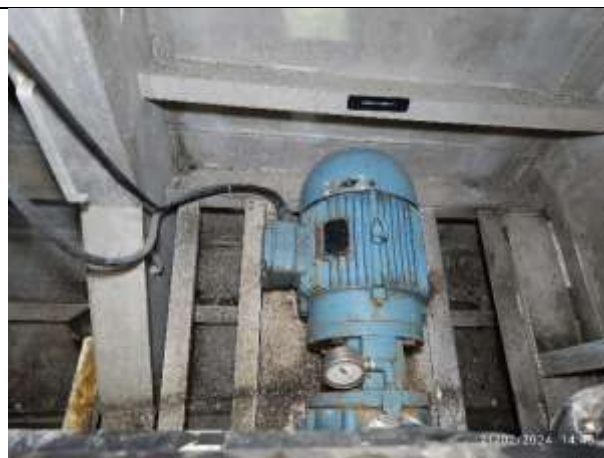
112. Bomba de esgoto
