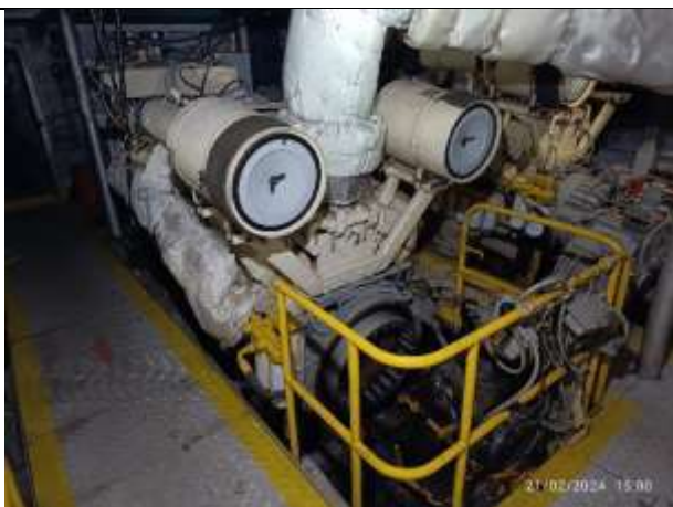
103. Motor propulsor nº 3
