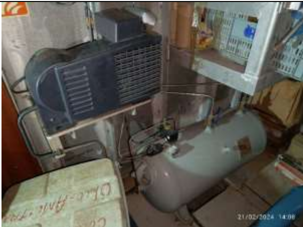
83. Compressor de ar de emergência
