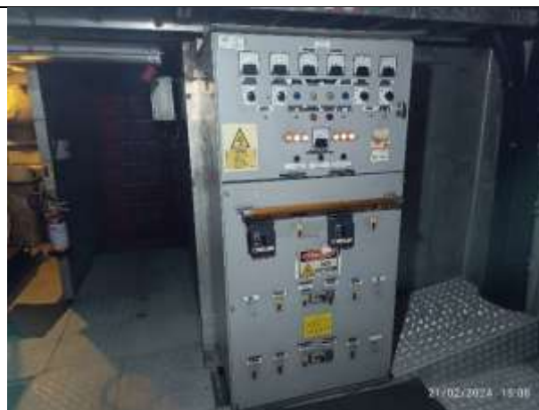
116. Quadro elétrico principal
