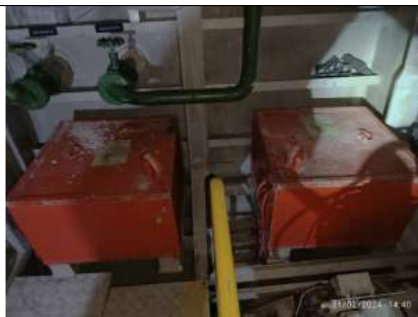
114. Baterias do sistema de partida dos MCPs 1 e 2
