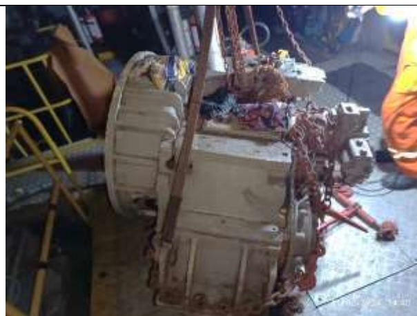
104. Redutora do motor propulsor nº 3
