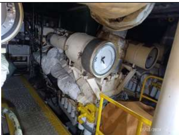
101. Motor propulsor nº 2
