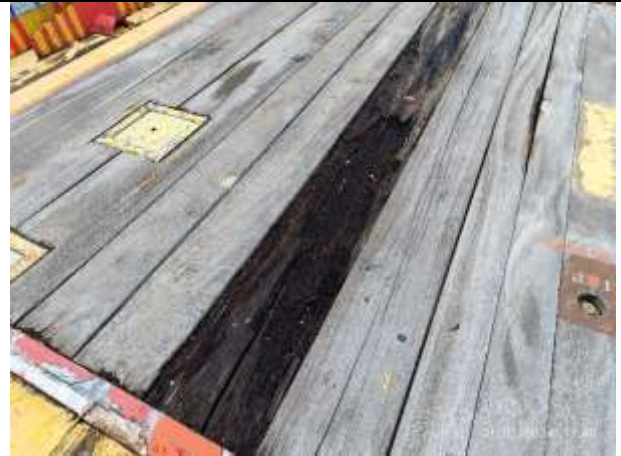
8. Madeirame deteriorado no convés da popa
