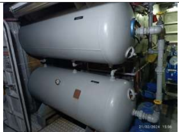
88. Reservatórios de ar
