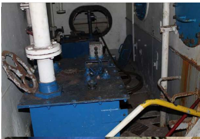
- Unidades de tratamento séptico e bomba de transferência de dejetos.
