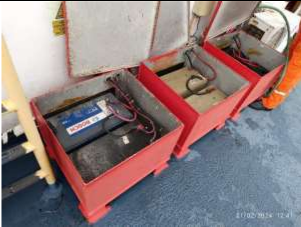
19. Baterias para equipamentos do passadiço
