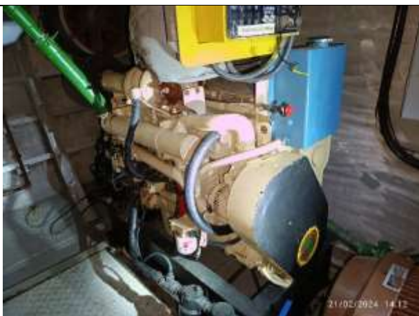
97. Motor diesel da bomba hidráulica do propulsor azimutal
