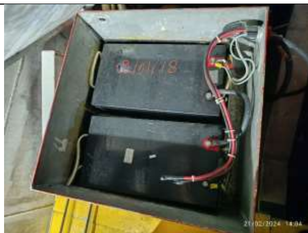
82. Baterias dos sistemas de emergência, bombas sanitárias e sistema de comando do propulsor azimutal
