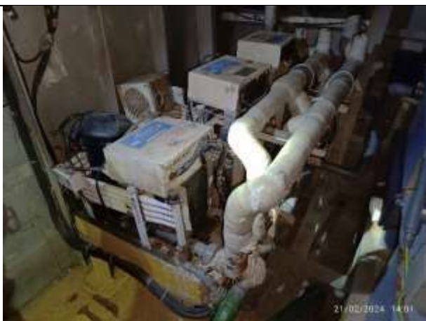
79. Unidades compressoras do ar condicionado central
