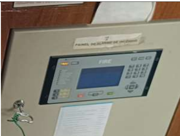
33. Painel de alarme de incêndio
