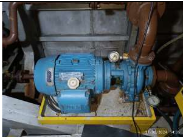
108. Bomba de transferência de óleo diesel
