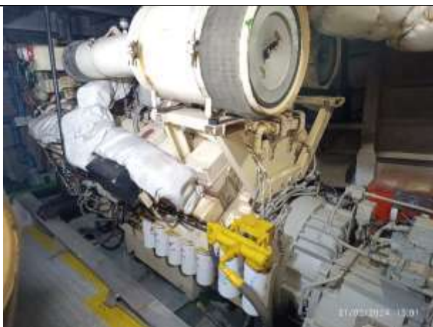
105. Motor propulsor nº 4
