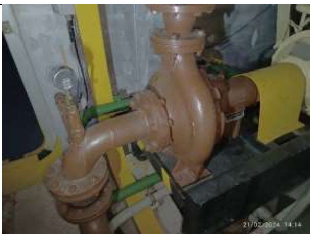
93. Bomba de lama/óleo diesel de carga acionada por motor diesel
