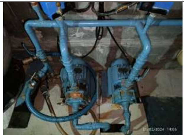
86. Bombas do sistema hidrofor
