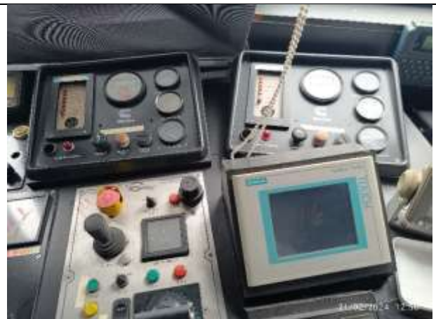
52. Painéis de comando e supervisão do MCP 4
