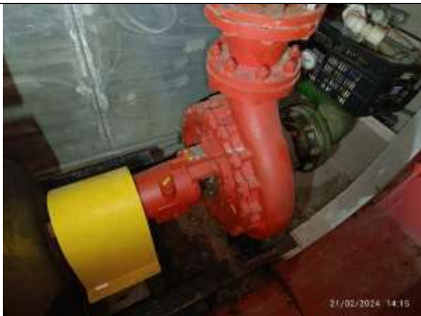
95. Bomba do canhão de incêndio
