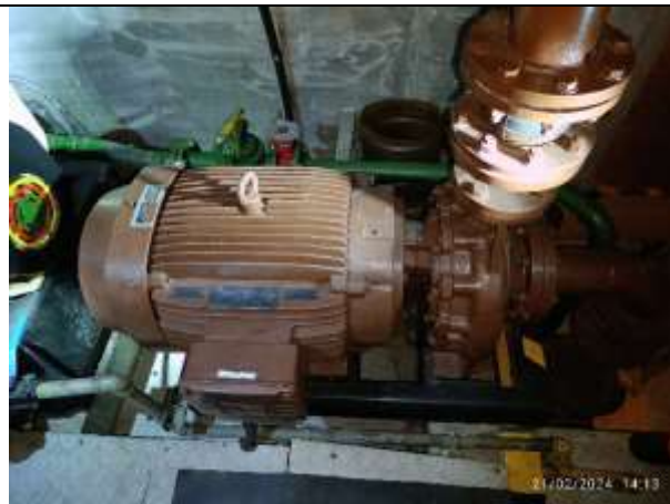
96. Bomba elétrica de lama/óleo diesel de carga
