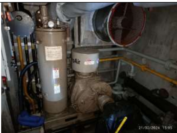
119. Compressor de granéis acionado pelo MCA nº 1
