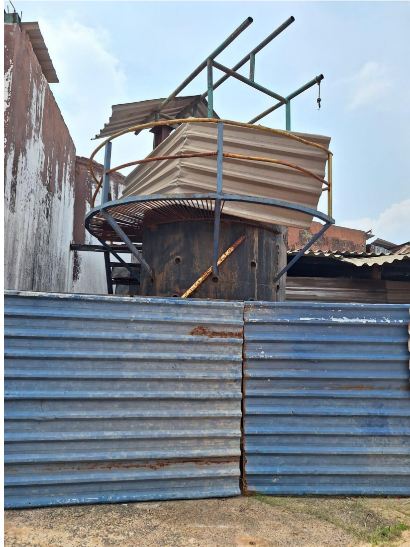
TANQUE DEPÓSITO DE CEBO
