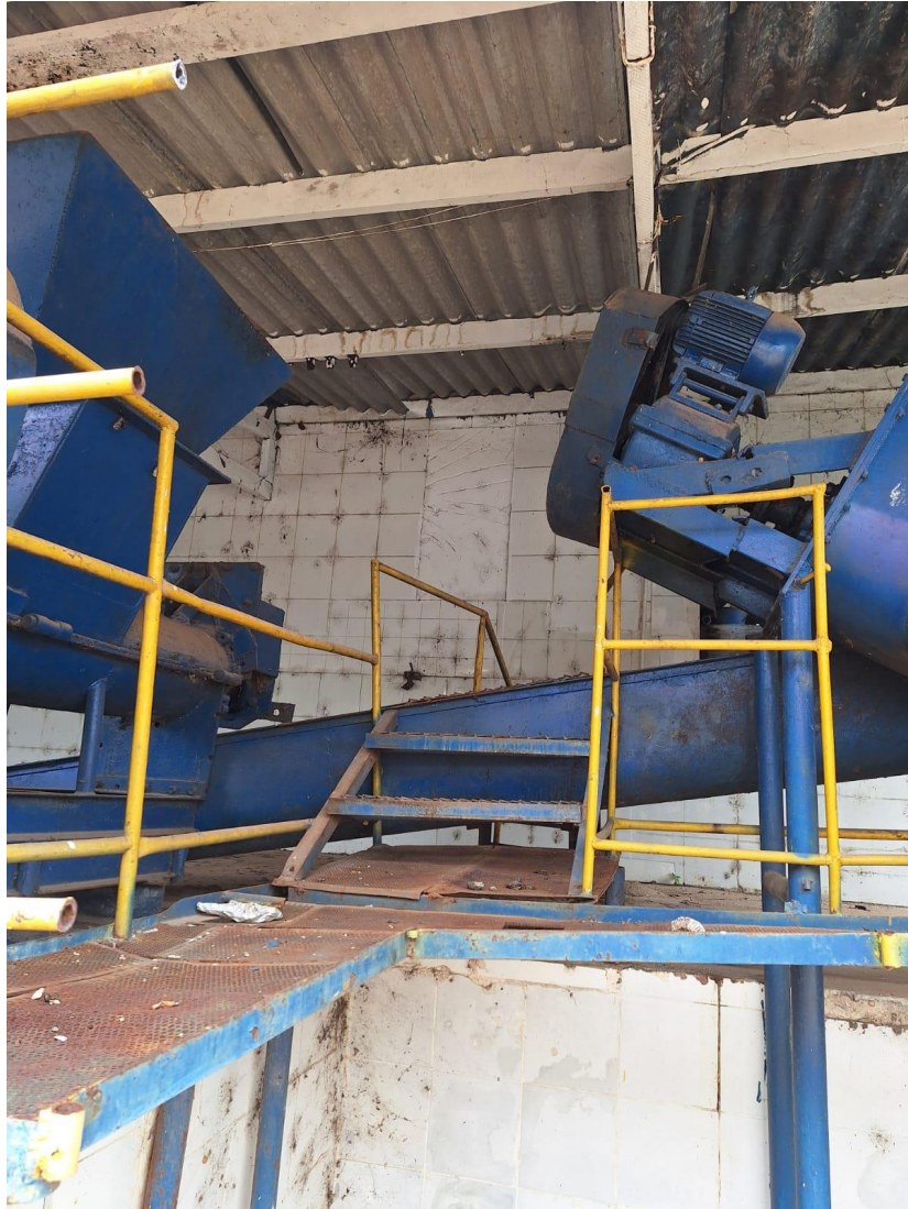
ROSCA ALIMENTADORA DOS DIGESTORES
