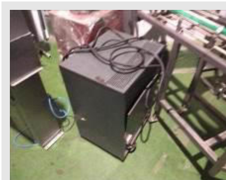
CARREGADOR DE BATERIA TRACIONÁRIA MARCA KM, TIPO TRAC, MOD. KMV, 24V 30A, N.S. 1102092 | Item: 89 |
