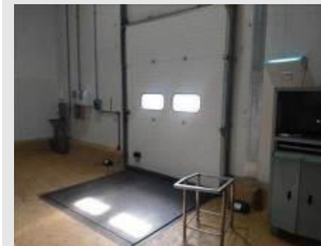
PLATAFORMA HIDRÁULICA NIVELADORA MARCA RITE HITE, MOD. HD-1400 | Item: 69 |
