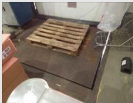
PLATAFORMA HIDRÁULICA NIVELADORA MARCA RITE HITE, MOD. HD-1400 | Item: 65 |
