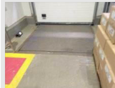
PLATAFORMA HIDRÁULICA NIVELADORA MARCA RITE HITE, MOD. HD-1400 | Item: 66 |
