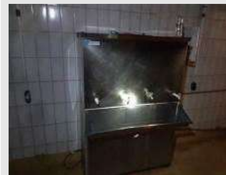
BEBEDOURO EM AÇO INOX MARCA CÂNOVAS COM 4 TORNEIRAS | Item: 9 |
