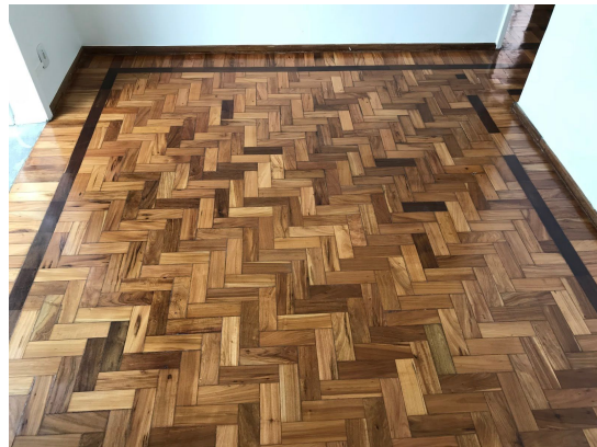
QUARTO 3 - DETALHE PISO
