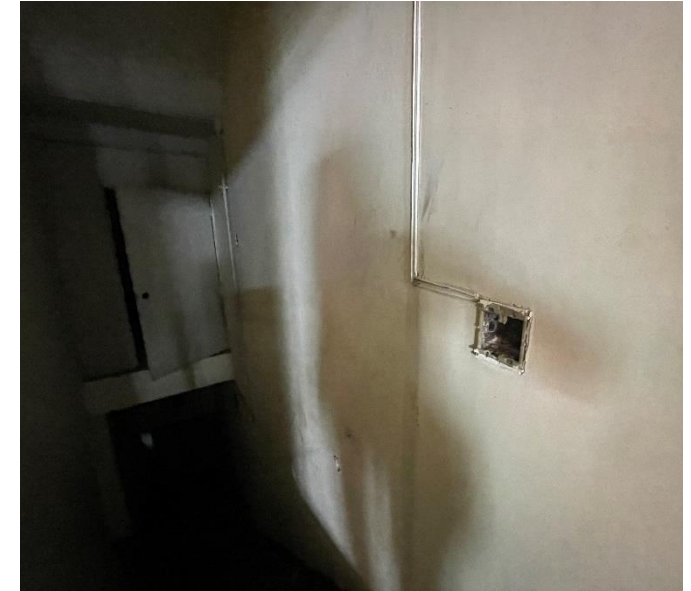
Avarias ponto elétrico - Térreo
