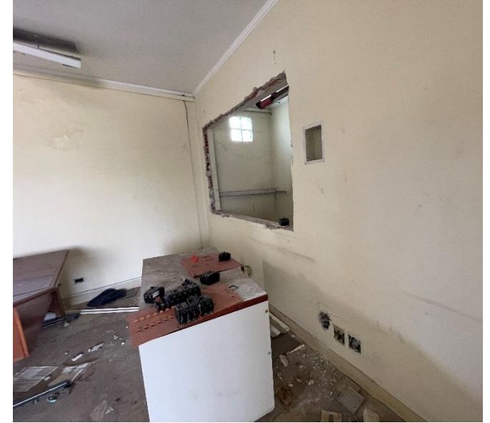
Avarias - esquadrias – 2º pavimento
