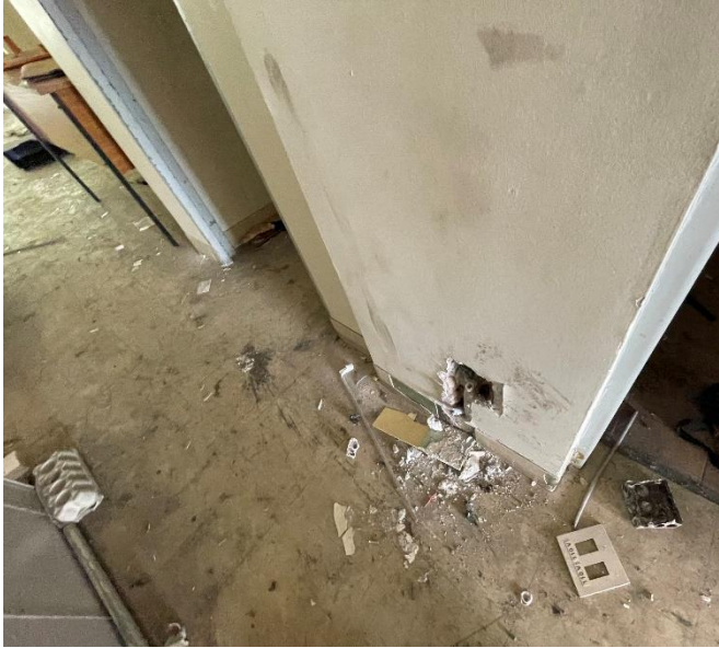
Avarias – ponto elétrico – 1º pavimento
