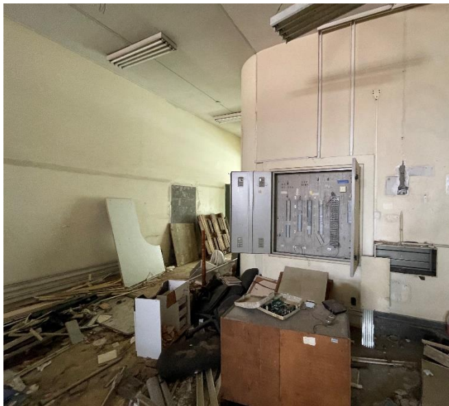
Avarias - quadro elétrico - salão - Térreo
