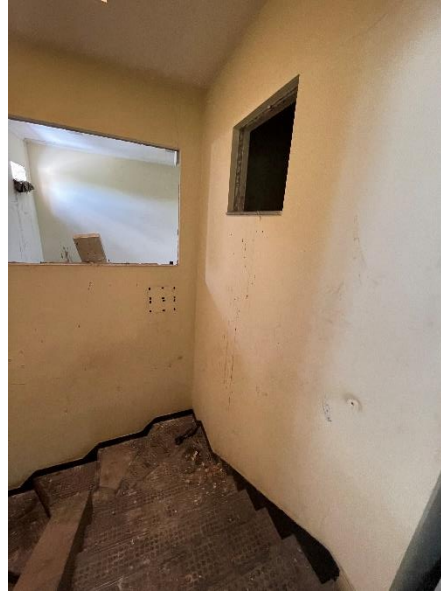
Avarias - esquadrias – escadaria
