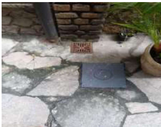
Rede de Água Fria, Pluviais com tubos
