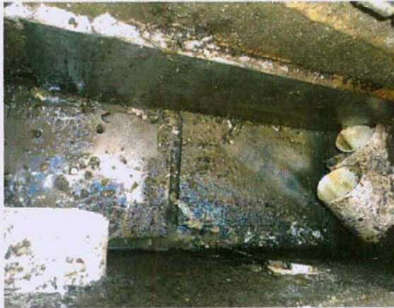
FOTO 25: Rede de esgoto trocada
