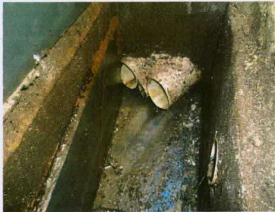
FOTO 27: Rede de esgoto trocada
