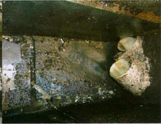
FOTO 26: Rede de esgoto trocada
