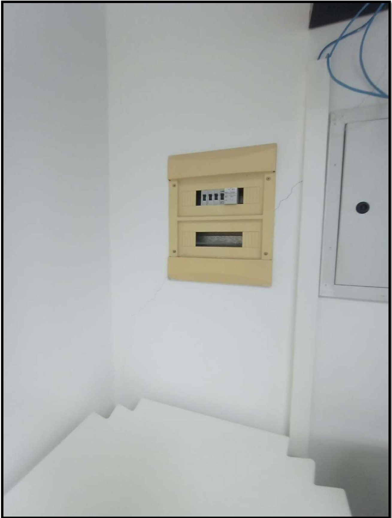
MARCAS DE TRINCAS NA PAREDE (SALA 02)
