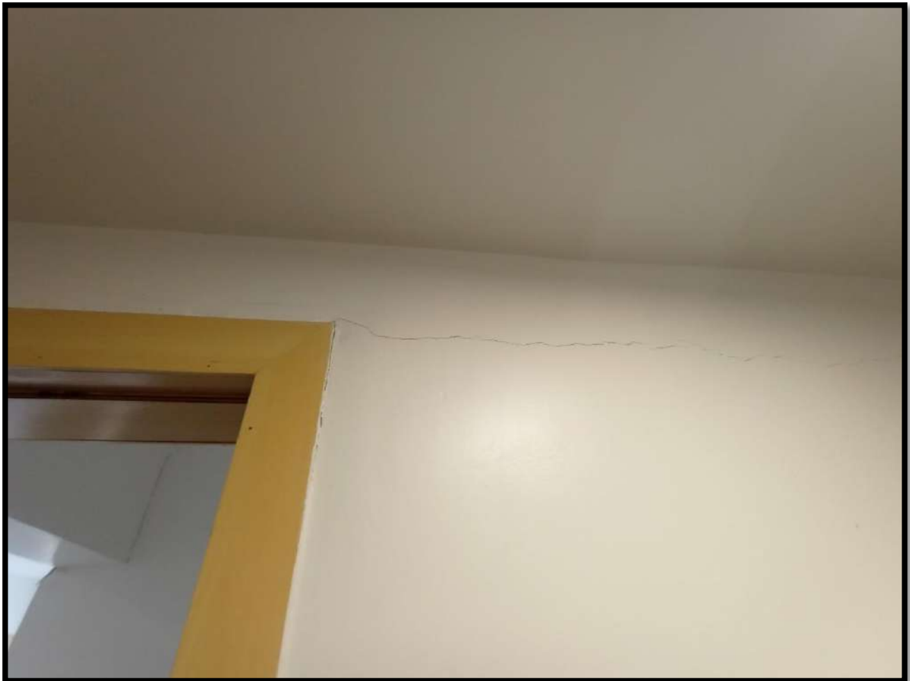
TRINCA NA PAREDE
