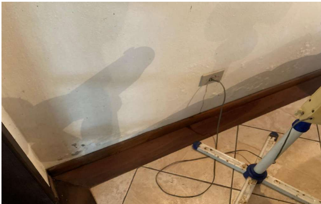
Infiltração aparente – sala de estar
