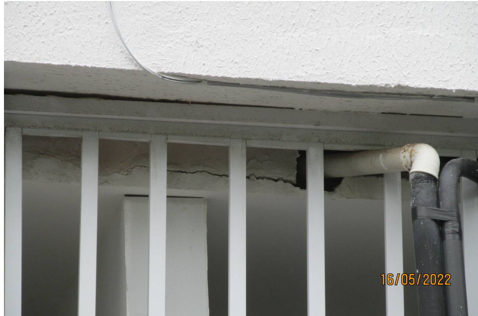
Foto 8) Detalhe vão sem caixilho onde se observa destaque do forro em relação ao acabamento lateral e parede em "dry wall" descolada do forro.
