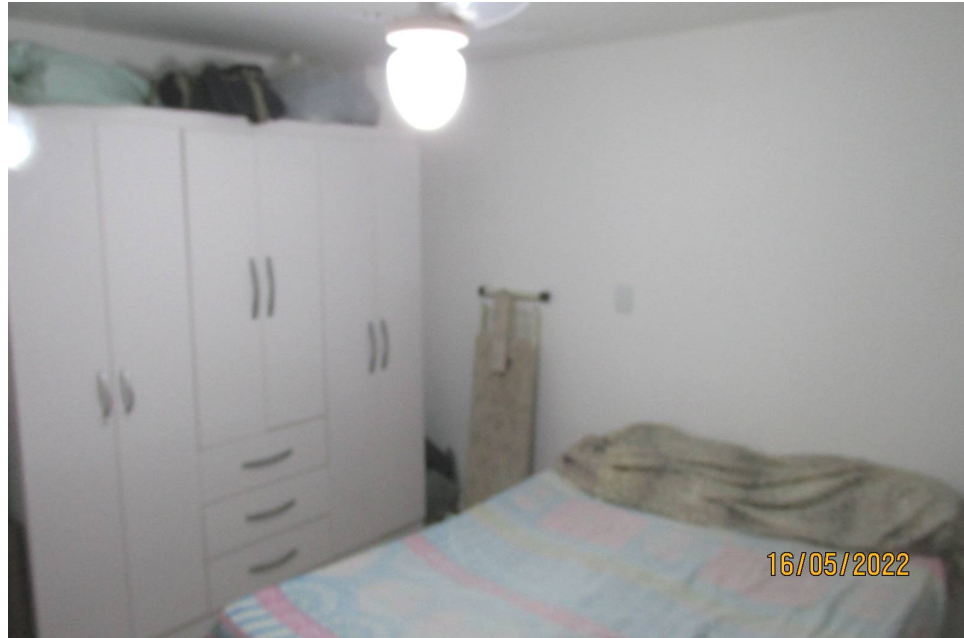
Foto 16) Vista do dormitório. Observar acabamento de piso, paredes e teto e ausência de aberturas destinada a iluminação e ventilação.
