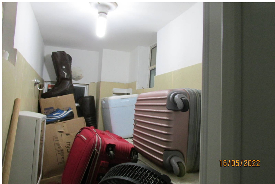
Foto 33) Vista da área técnica, onde se tem caixilhos dos demais apartamentos, tratando-se de dependência fechada; não uma área aberta.
