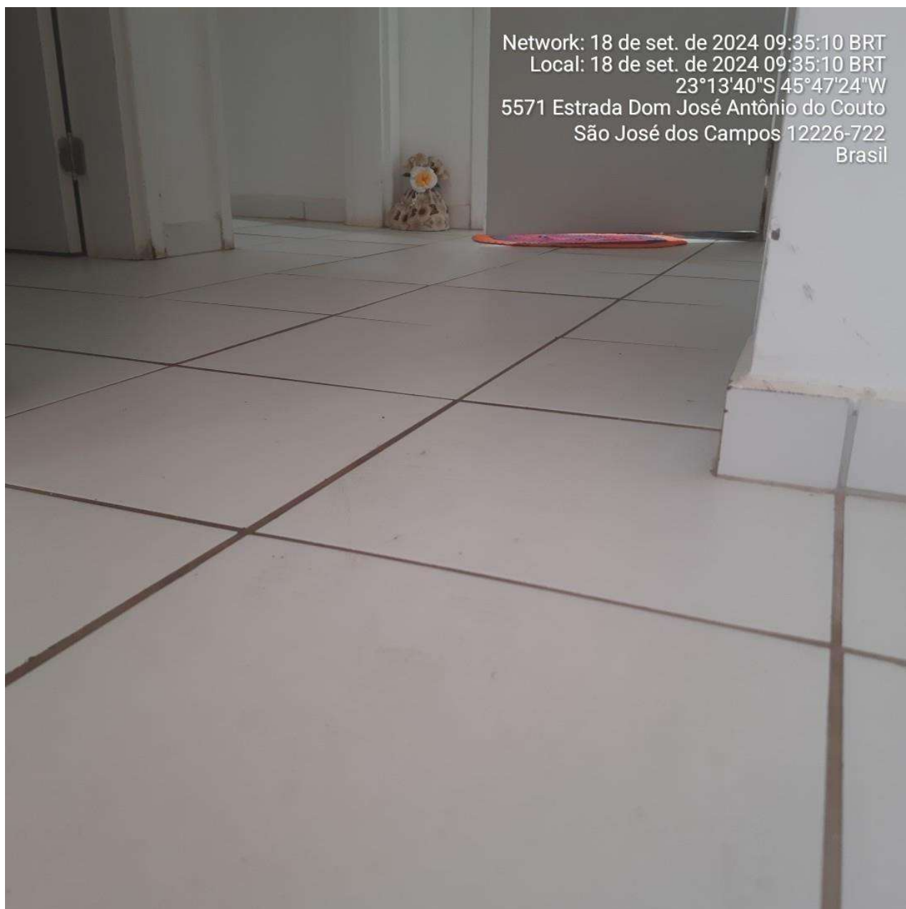
Fotografia Vistoria 13 – Apto nº 02 – Imóvel situação-paradigma – sala (piso cerâmico 35x35cm) – fonte: Eng. André Teixeira.
