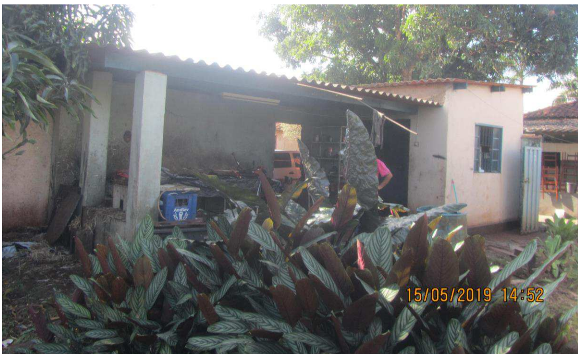
FOTO 18> Detalhe fundos do imóvel 02 (quintal), construção em estado de predação.
