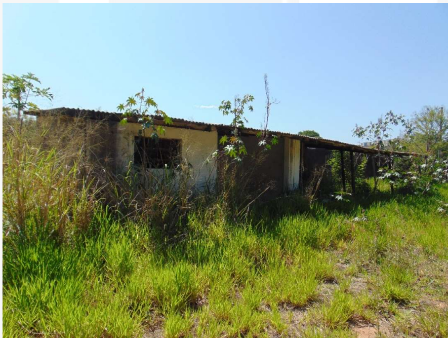
Figura 4.13 Edificação 3 estado de ruína
