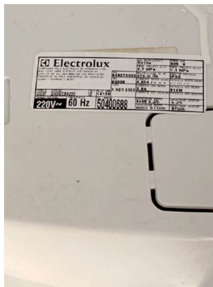
AR CONDICIONADO SPLIT ELETROLUX, 220 V, 9000 BTUS.
