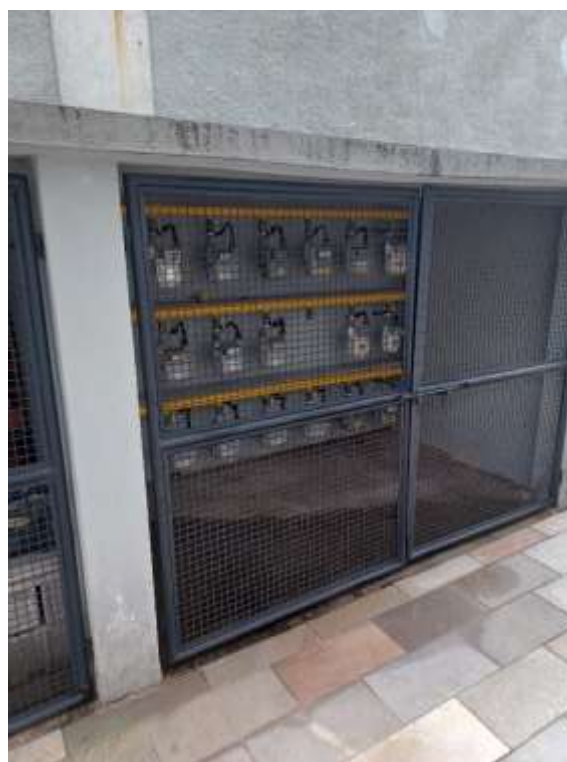
Foto 22: Central de gás
