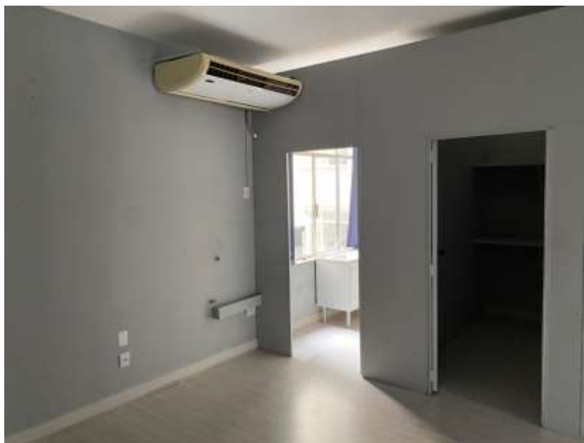
Foto 03 – Ar condicionado, copa e depósito
