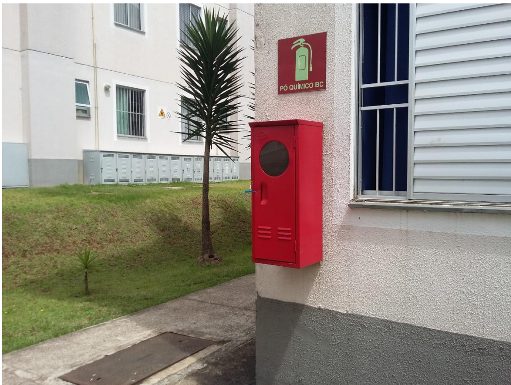
Figura 10 – Detalhe de equipamento de combate a incêndio.
