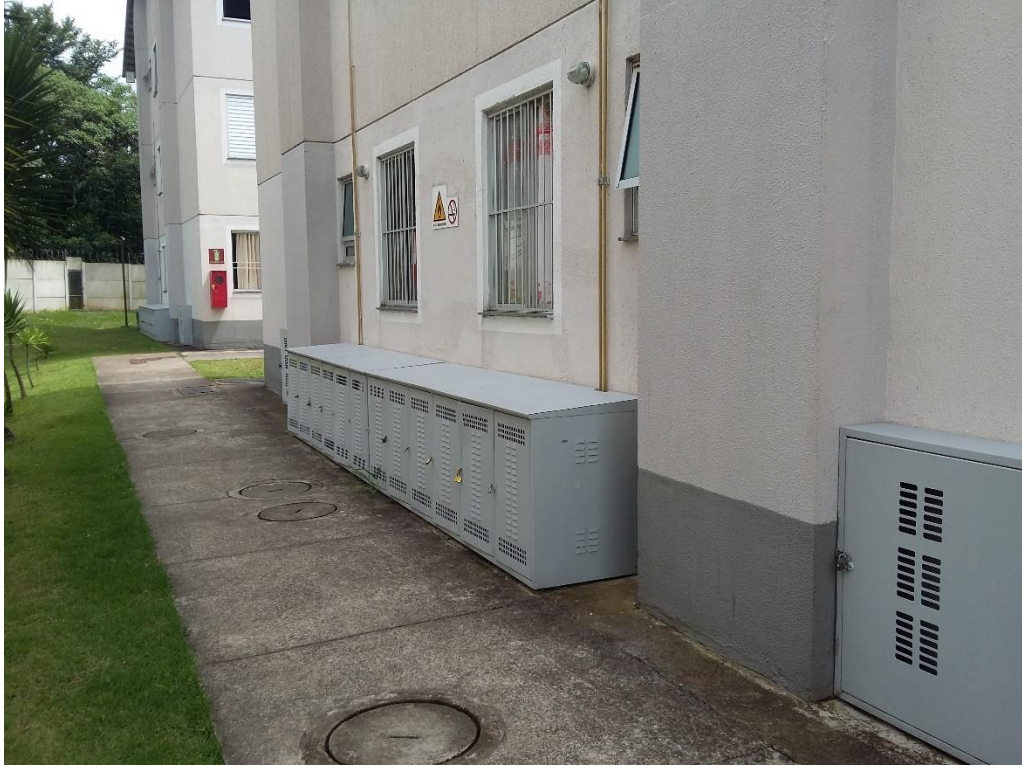
Figura 11 – Detalhe de abrigos de gás.
