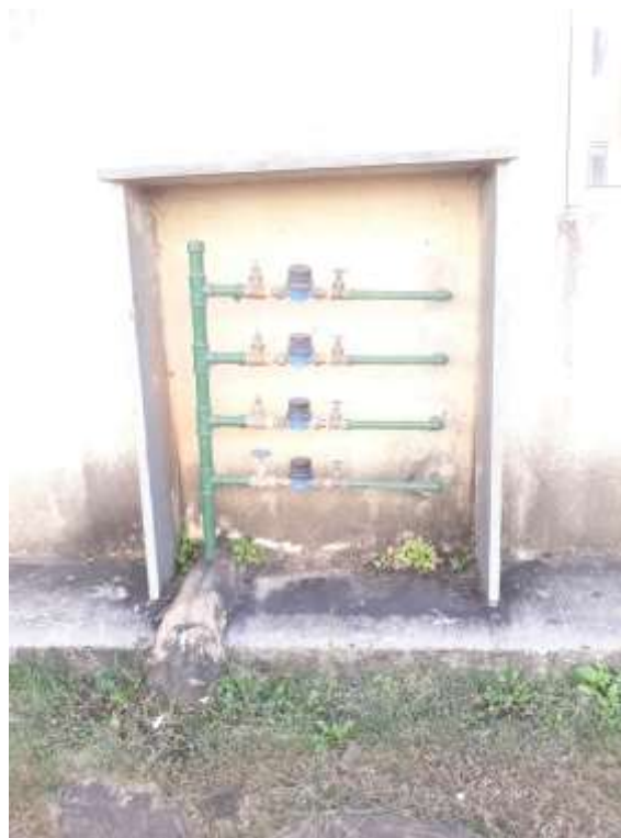
4 - Hidrômetros do Bloco 04
