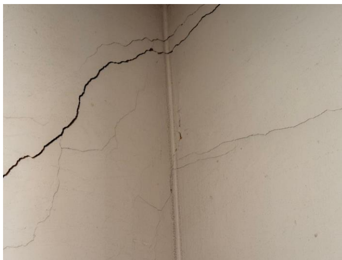
Foto 05. Trincas em parede recalque de fundação
