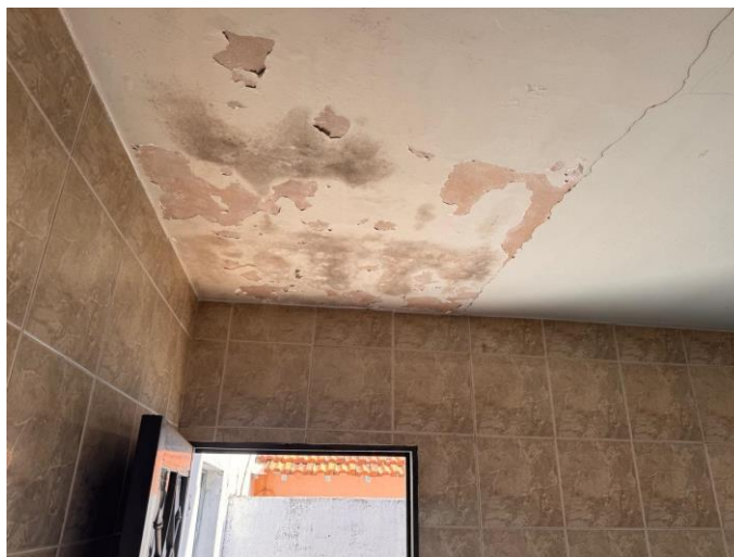
Foto 06. Infiltração d'água no teto do cozinha
