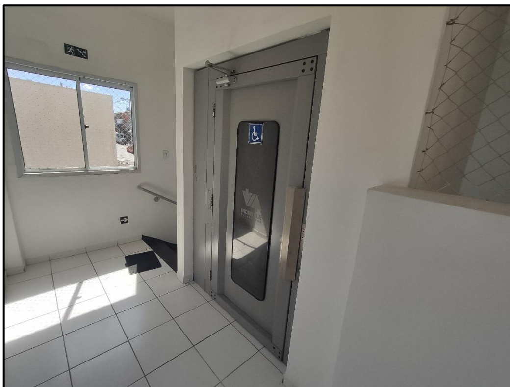
Ilustração 15: Área comum do condomínio – Plataforma elevatória
