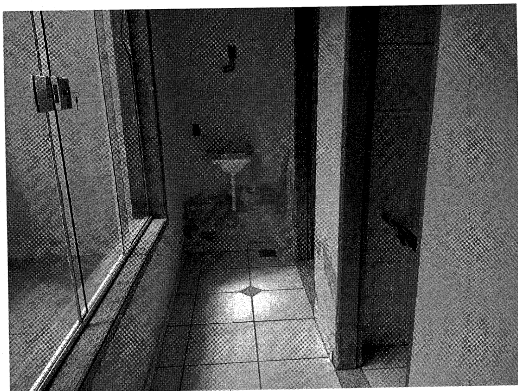
Vista sanitários churrasqueira e área luz – paredes e teto s/ acabamento
