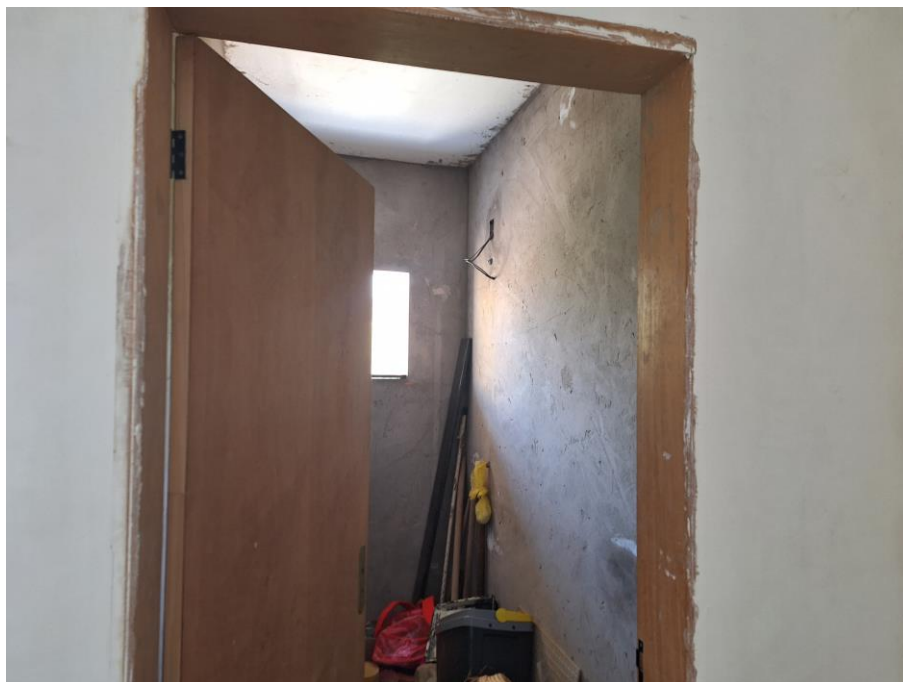
Imagem 100 – Vista Interna – SUÍTE. Vista para porta de acesso ao banheiro da suíte.
