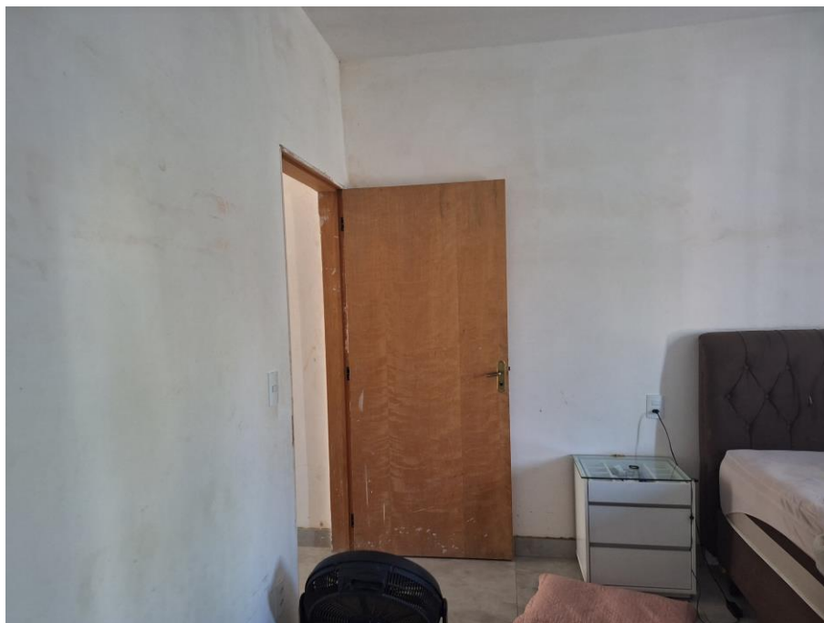
Imagem 96 – Vista Interna – SUÍTE. Paredes em alvenaria / reboco / pintura. Piso cerâmico. Esquadrias em alumínio. Acesso franqueado pelo Executado.
