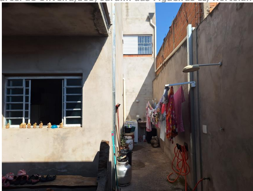
Imagem 41 – Vista Interna – ÁREA DE LAZER. Vista para área de lazer / churrasqueira da residência. Paredes em alvenaria / reboco (obra não finalizada). Piso cimentado. Cobertura em telha cerâmica e estrutura em madeira.
