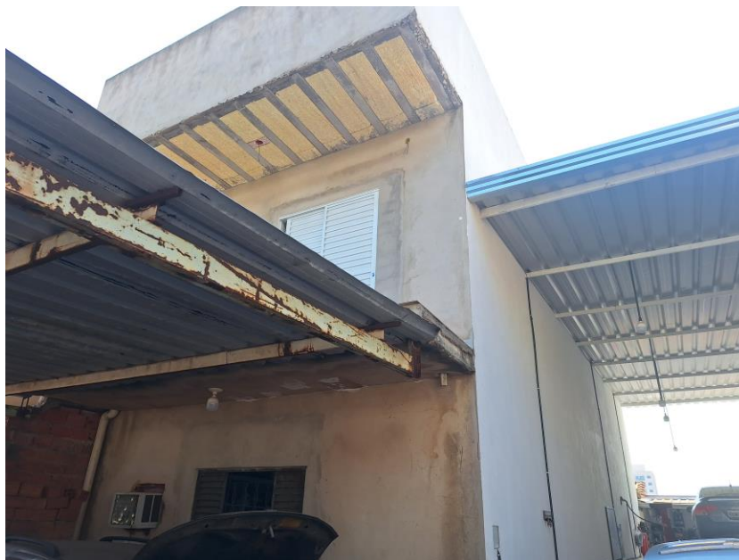
Imagem 22 – Vista Interna – OFICINA MECÂNICA. Paredes em alvenaria / reboco / parte com acabamento em pintura. Piso cimentado. Cobertura em estrutura metálica. Vista para carros em espera e em manutenção.
