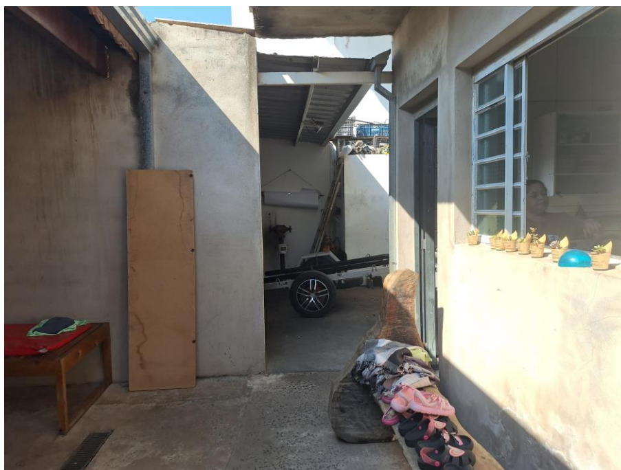
Imagem 42 – Vista Interna – ÁREA DE LAZER. Vista para porta de acesso à cozinha e passagem para oficina. Paredes em alvenaria / reboco (obra não finalizada). Piso cimentado. Acesso franqueado pelo Executado.
