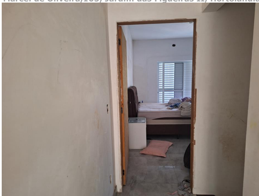
Imagem 93 – Vista Interna – CIRCULAÇÃO. Vista para suíte da residência. Paredes em alvenaria / reboco / pintura. Piso cerâmico. Esquadrias em madeira.
