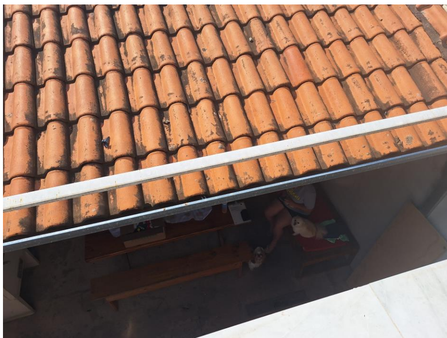
Imagem 83 – Vista Interna – SACADA DORMITÓRIO. Paredes em alvenaria / reboco (obra não finalizada). Piso cerâmico. Esquadrias em madeira e alumínio. Vista para coberturas e área inferior (térreo). Acesso franqueado pelo Executado.
