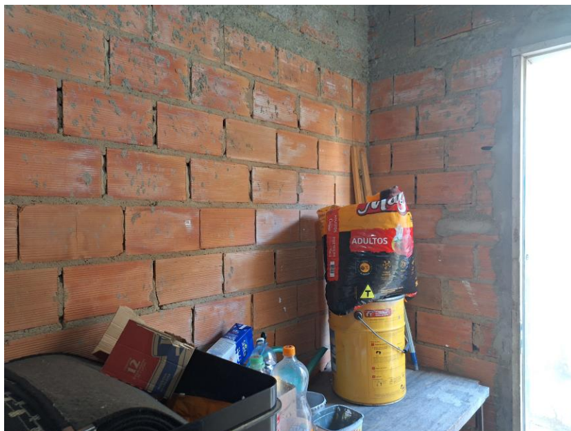
Imagem 64 – Vista Interna – DEPÓSITO. Paredes em alvenaria (sem acabamento). Piso cimentado. Esquadrias em alumínio. Acesso franqueado pelo EXECUTADO.
