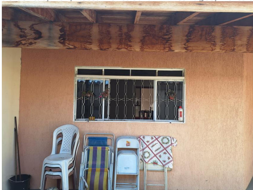
Imagem 17 – Vista Interna – GARAGEM. Vista para garagem da residência. Muros em alvenaria. Paredes em alvenaria / reboco / pintura. Esquadrias em alumínio. Piso cimentado. Cobertura cerâmica com estrutura de madeira.
