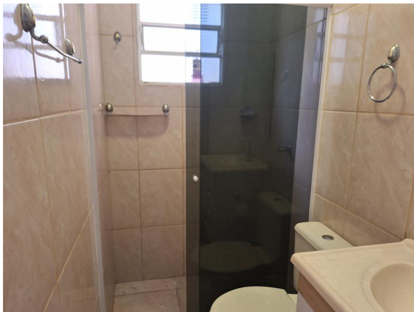
Imagem 76 – Vista Interna – CASA FUNDOS. BANHEIRO. Paredes em alvenaria / reboco / revestimento cerâmico. Piso com revestimento cerâmico. Forro de PVC.
