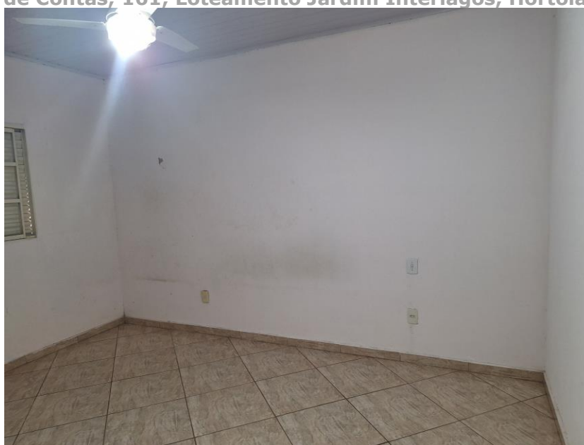
Imagem 79 – Vista Interna – CASA FUNDOS. DORMITÓRIO. Paredes em alvenaria / reboco / pintura. Piso com revestimento cerâmico. Forro de PVC.
