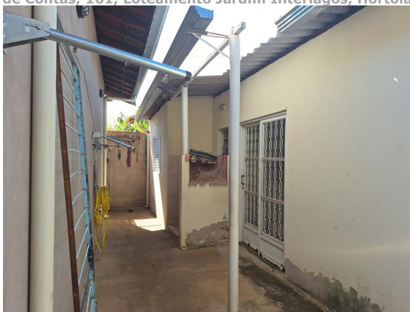
Imagem 71 – Vista Interna – CASA FUNDOS. Paredes em alvenaria / reboco / pintura. Piso cimentado. Porta de ferro e vidro. Cobertura em telha de fibrocimento e estrutura em madeira. Acesso franqueado pelo EXECUTADO.
