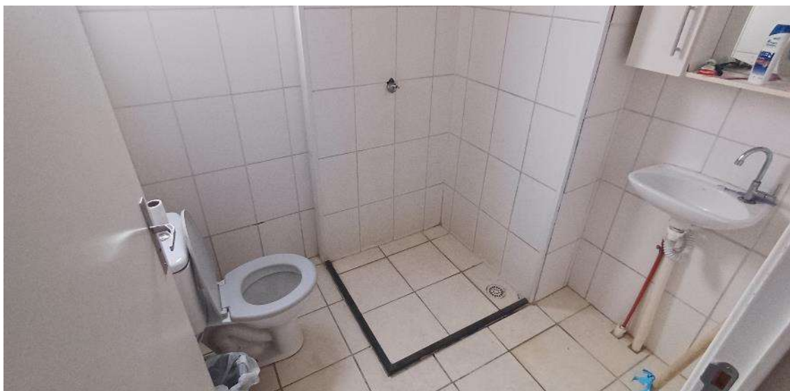
Objeto Pericial – Lavabo/Banheiro.
