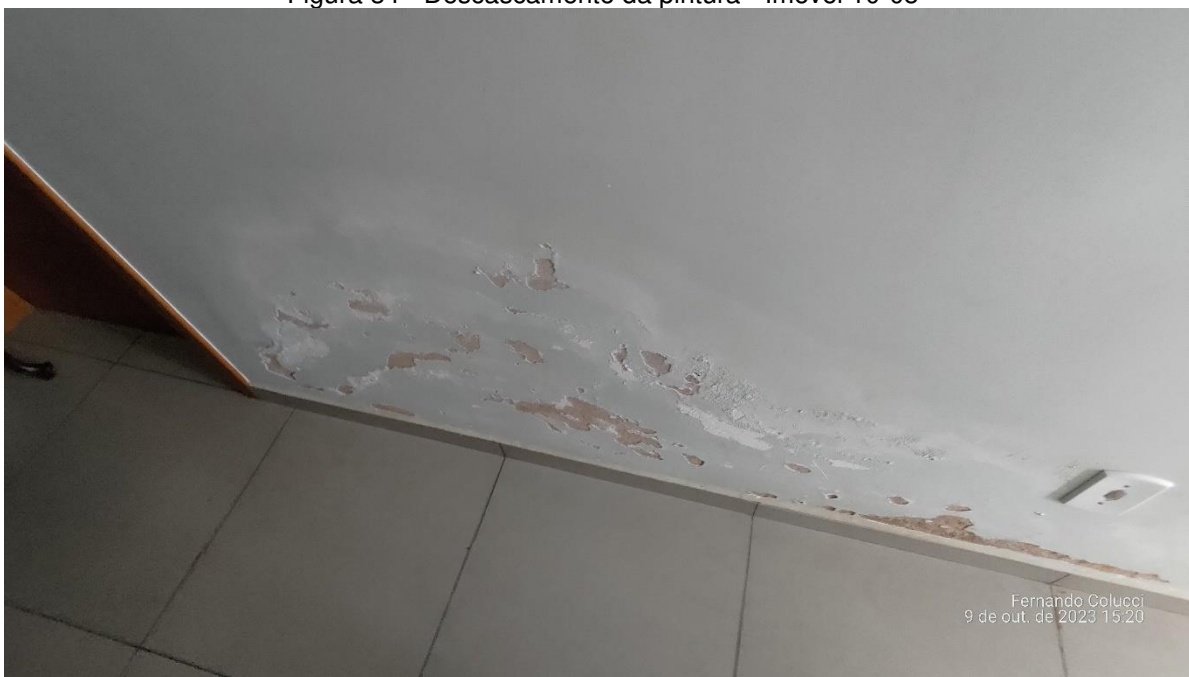
Figura 34 - Descascamento da pintura - Imóvel 10-05
