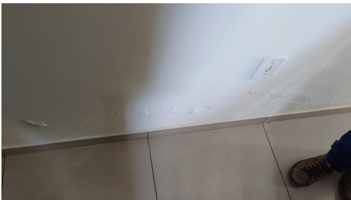
Figura 36 - Presença de bolhas - Imóvel 10-15
