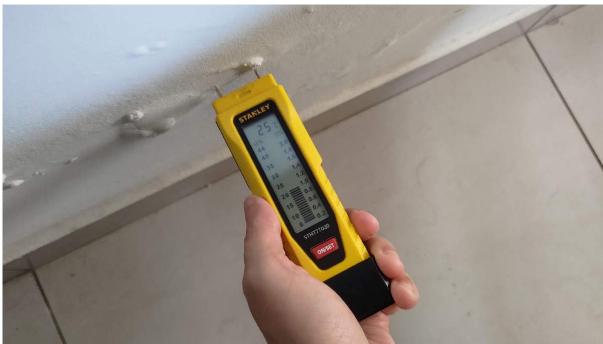
Figura 37 - Umidade medida em 1,0% - Imóvel 10-15
