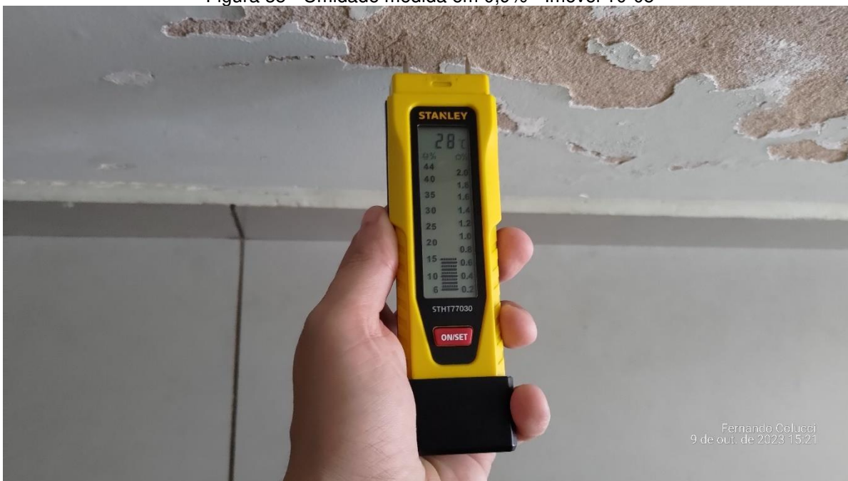
Figura 35 - Umidade medida em 0,9% - Imóvel 10-05
