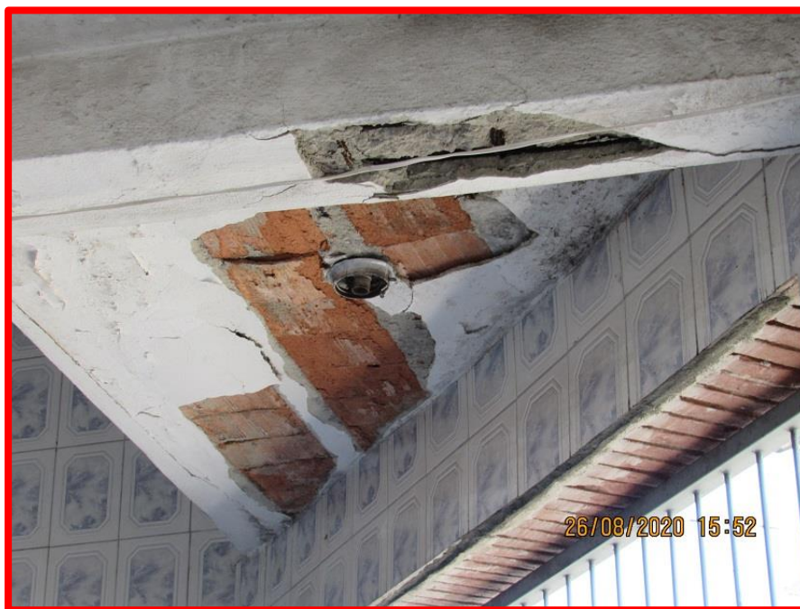
FOTO 15: Laje com armadura exposta.
