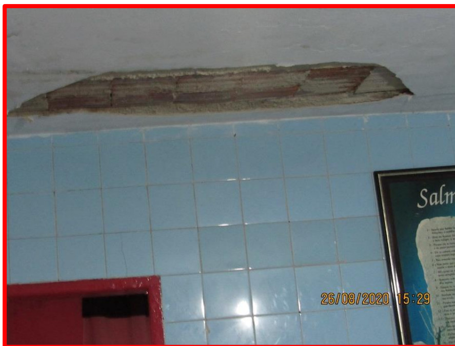
FOTO 14: Laje com deslocamento de reboco.
