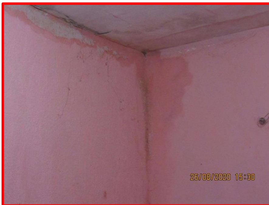
FOTO 10: Infiltração em algumas paredes.
