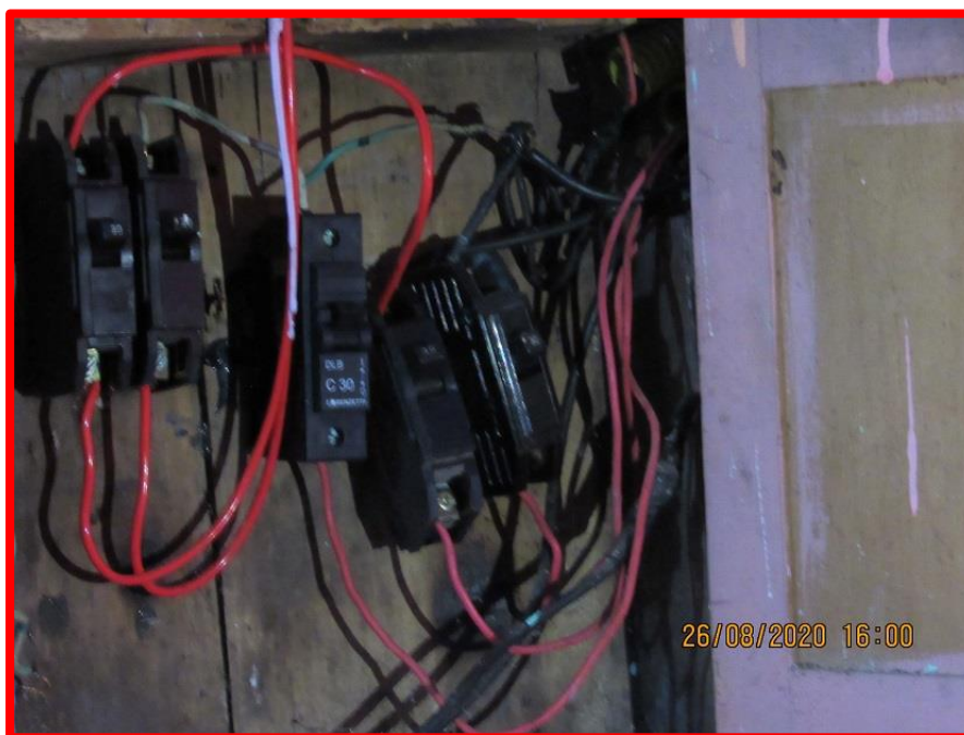
FOTO 12: Instalação elétrica em desconformidade com a Norma.
