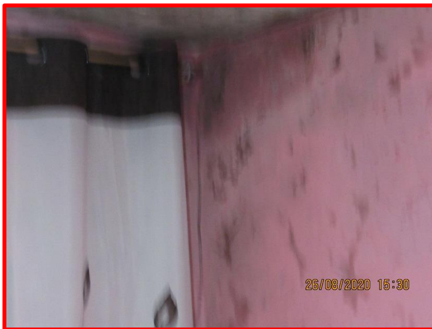
FOTO 11: Mofo em algumas paredes.
