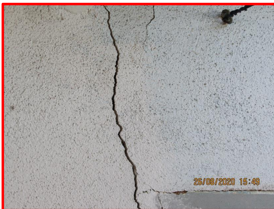
FOTO 13: Rachaduras em algumas paredes.
